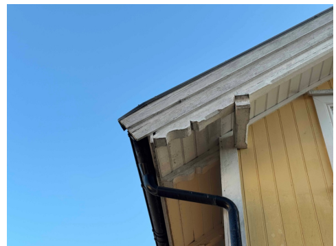
Vindskibord med råteskader
