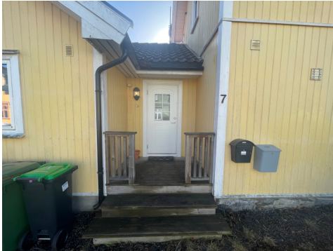
Trapp mangler rekkverk
