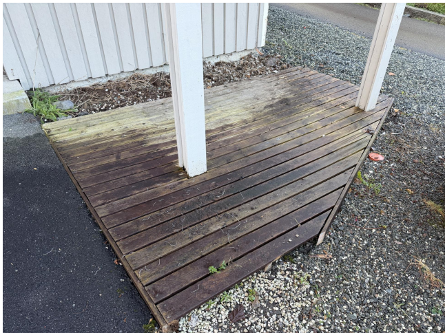
Råteskader i terrasse.
