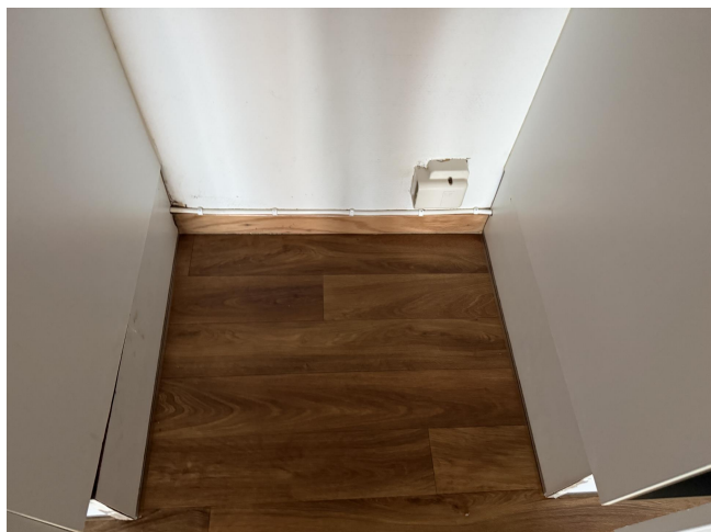
Her ble det indikert fuktighet under benkeplate på kjøkken på gulv og i vegg.
