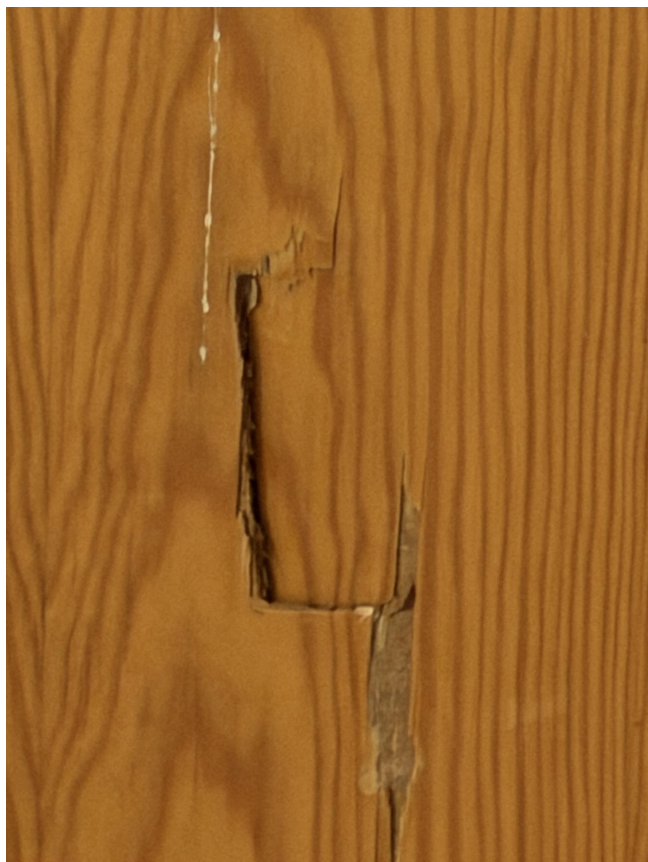
Skade på innvendig dør til bod.
