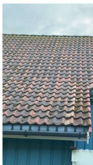
Eldre taktekking med mose og slitasje.
