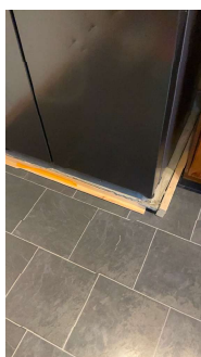
Ikke ferdigstillelse av under lage under kjøleskap.
