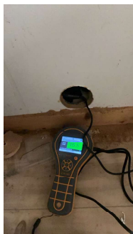
Svakt forhøyede fuktverdier måles ved hullboring
