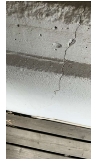
Sprekker i mur og mur med setningskader.
