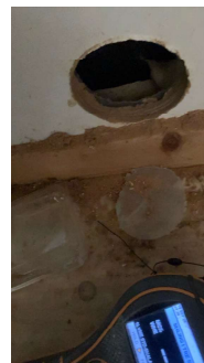
Bruk av plast mot murvegg under terreng kan skape fuktproblemer
