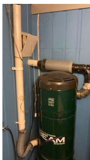
Eldre sentral støvsuger der halvparten av normal levetid er passert
