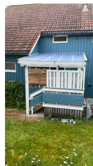
Manglende beslag og skjevheter i takkonstruksjon over veranda.
