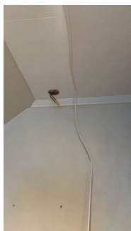
Løse ledninger flere plasser registreres
