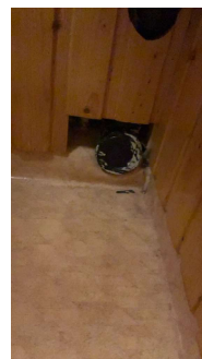
Åpning i vegg og overflater som ikke tåler fukt
