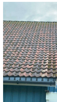
Manglende snøfangere på tak over veranda på baksiden
