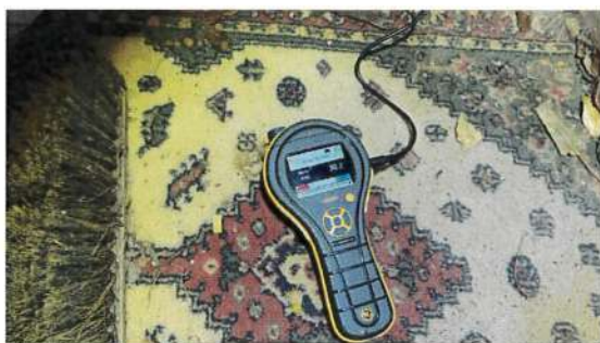
Det er målt fukt flere plasser i nedre del av yttervegger
