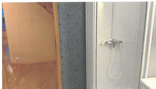
Dør er plassert i våtsone til dusjkabinett.
