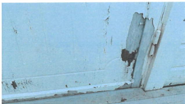
Terrassedør på kjøkken har råteskade.
