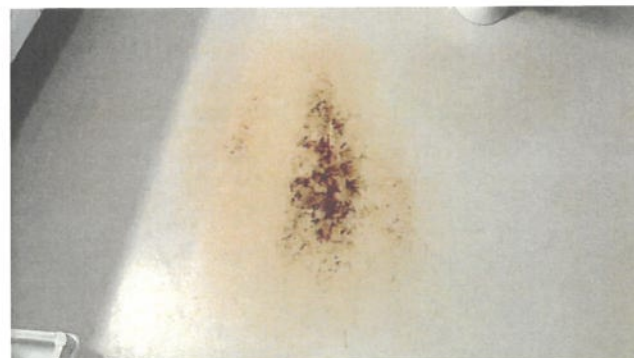
Gulvbelegg er misfarget.
