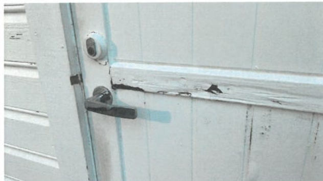
Utvendig boddør har markert råteskade.
