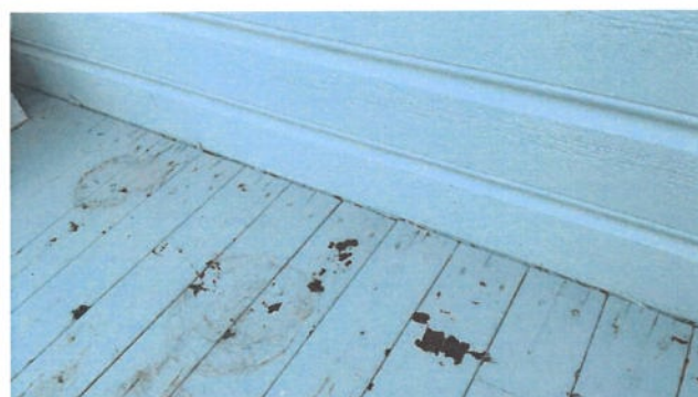
Veggen er vanskelig å vedlikeholde bak terrassebord.
