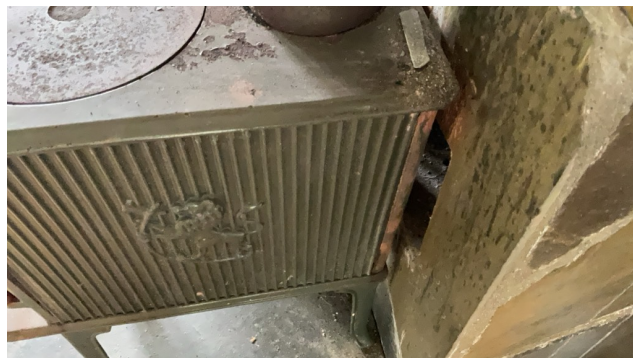
Ovn er plassert for nær til pipe ihenhold til krav
