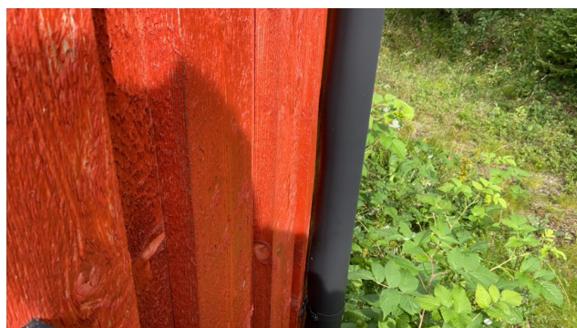
Frostspreng på nedløp
