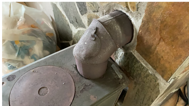
Slitasje/rust på røykrør med enkel innføring
