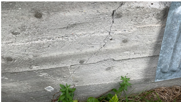
Sprekk i mur
