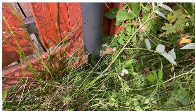
Manglende bortledning av takvann, bør føres vekk for å unngå oppfukning mot bygningskropp
