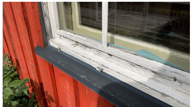
Vinduer er preget av elde og vedlikeholdsetterslep
