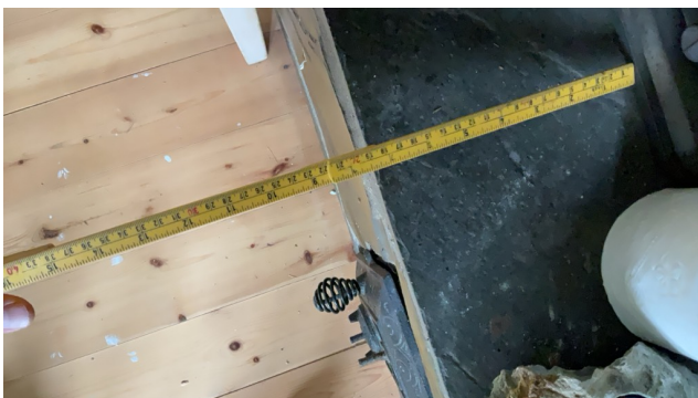
Avstand fra innsats til brennbart gulv er under krav om avstand til brennbart materiale
