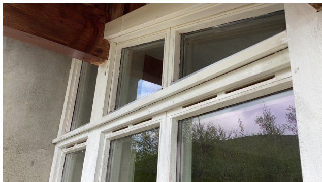
Viser vinduer tilbygg mot nord uten vannbrett.
