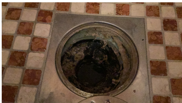
Viser gulvsluk i dusj
