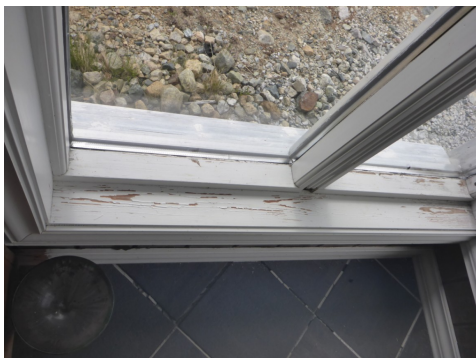
Viser vindu i stue preget av fukt innvendig.
