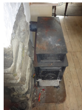
Viser vedovn med avstand < 10 cm fra brannmur/pipe.
