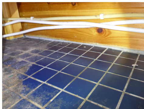
Viser kobberledninger som ikke er klamret.
