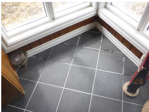
Viser område med sprekte gulvfliser i stue.
