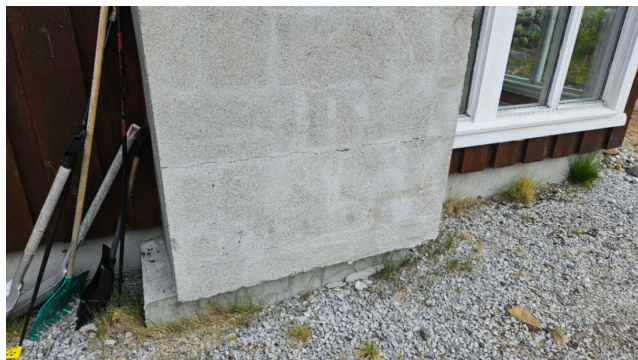
Viser fundament elementpipe med riss/sprekk.
