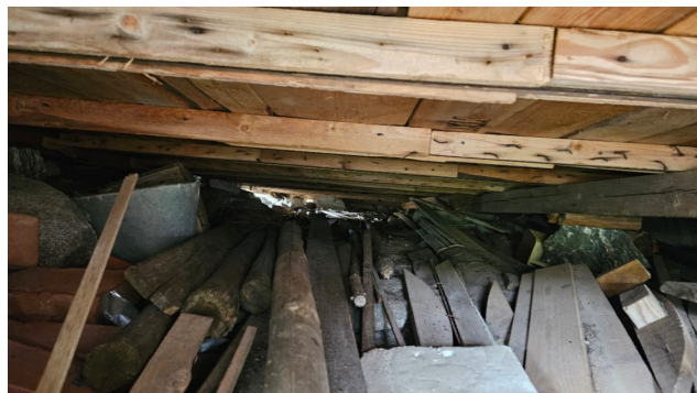
Viser krypkjeller sett fra luke med materialer som er lagret.
