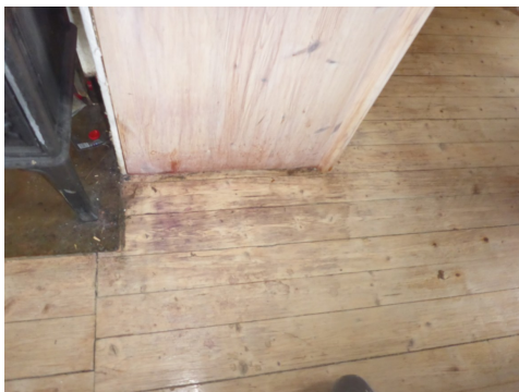
Viser slitasje på gulvoverflate i stue/kjøkken.
