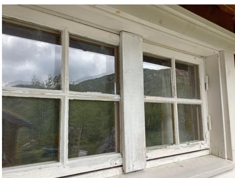
Viser vindu med værslitasje.
