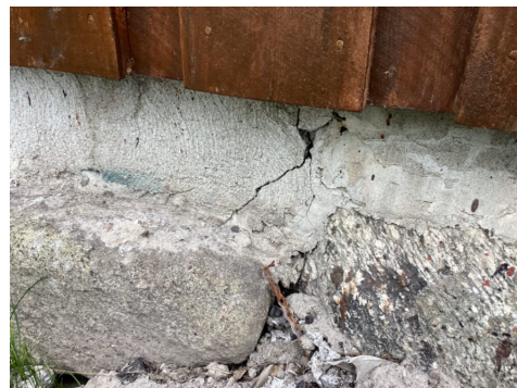
Viser ringmur med sprekk.
