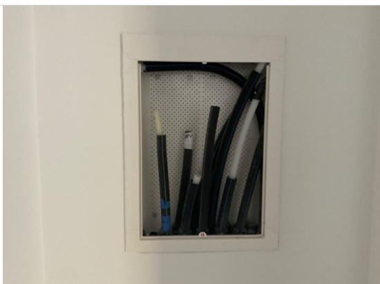
Bilder tatt på befaring. Vannskap.
