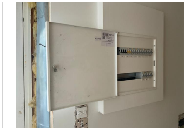
Bilder tatt på befaring. Bilde av fordelingsskap for strøm til hybel.
