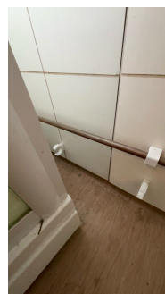
Fuktskade på yttervegg bak dusjkabinett.
