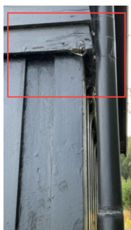
Det er påvist spredte råteskader i bordkledningen.
