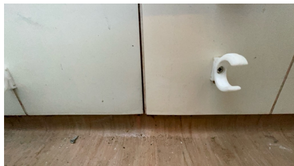
Fuktskade på yttervegg bak dusjkabinett.
