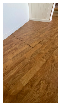
Manglende håndverksmessig utførelse på deler av arbeid.
