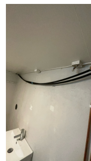
Det er påvist ufagmessig utførelse av vannledninger. Utilstrekkelig innfesting av rør registrert.
