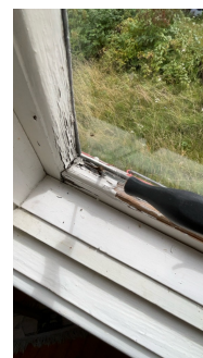
Det er påvist vinduer med fukt/råteskader.
