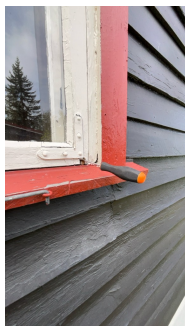
Det er påvist vinduer med fukt/råteskader.
