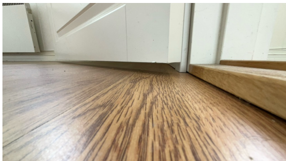
Punktskader på dører.
