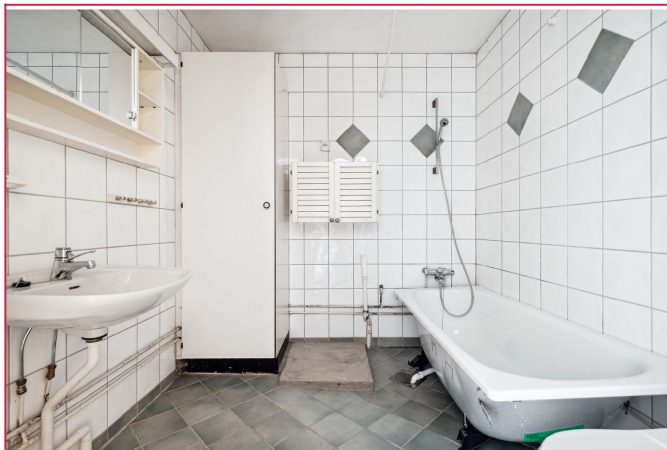
Badet har opplegg til vaskemaskin.
