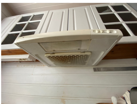
Bildet viser ventilator
