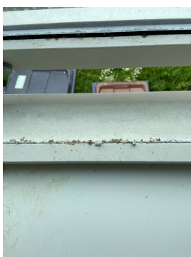
Bildet viser vindu med skade i pakning.
