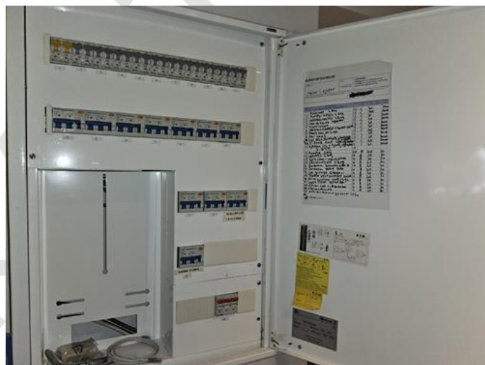
Elektrisk anlegg - [Sikringsskap 2. etg]
