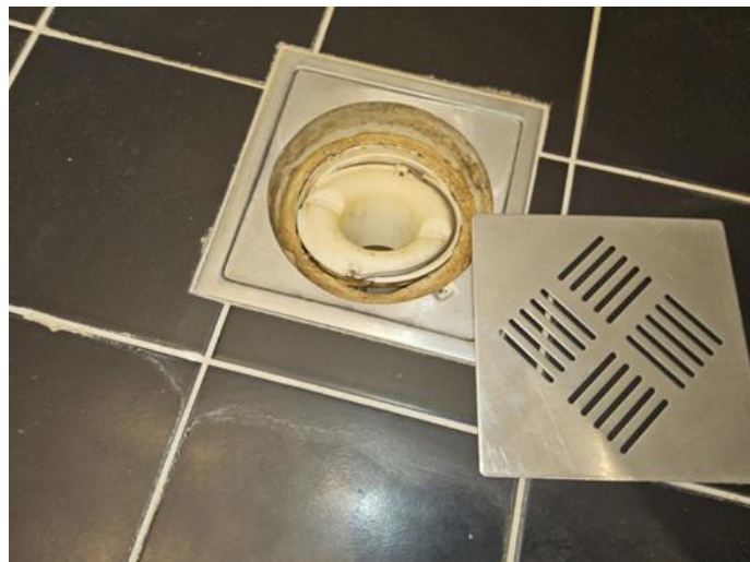
Avløpsrør (ink. sluk) - [Sluk bad loft.]
