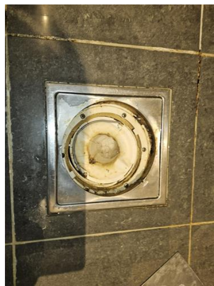
Avløpsrør (ink. sluk) - [Sluk bad 2. etg]
