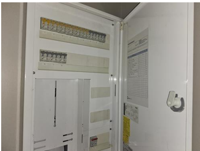
Elektrisk anlegg - [Sikringskap 1. etg vest.]
