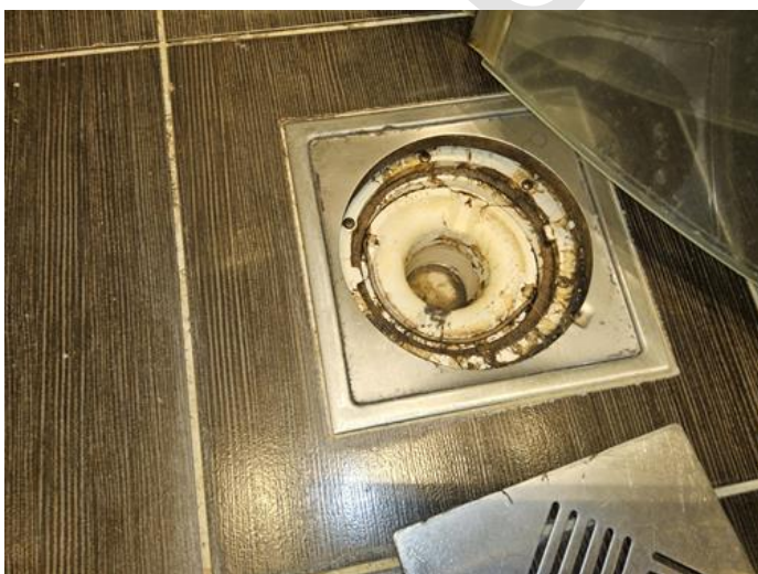
Avløpsrør (ink. sluk) - [Sluk bad 1. etg vest.]
