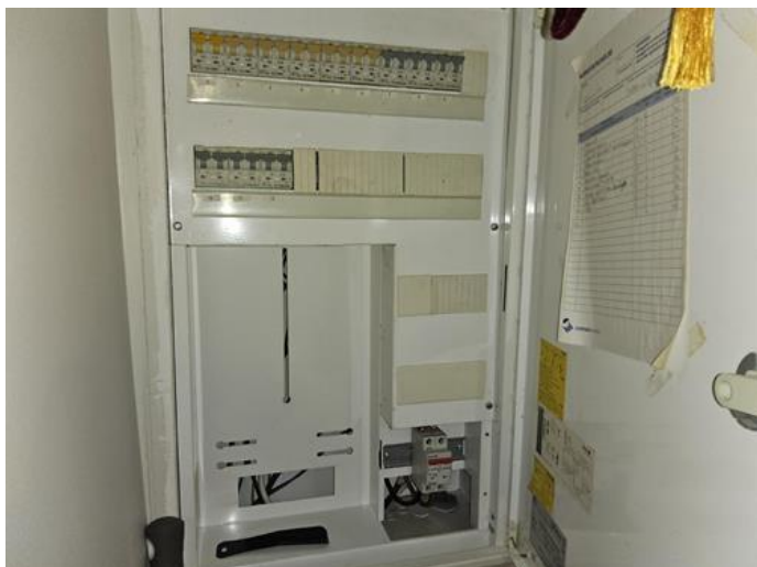
Elektrisk anlegg - [Sikringsskap 1. etg øst.]
