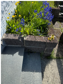
Riss i støttemur av splitt-Leca.
