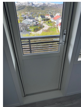
Balkongdør på hovedsoverom, skiftet i 2017.
