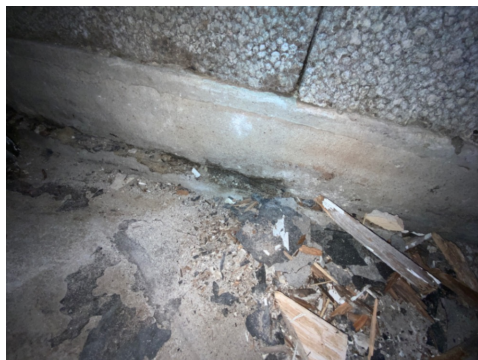
Fukt i overgang gulv og vegg.
