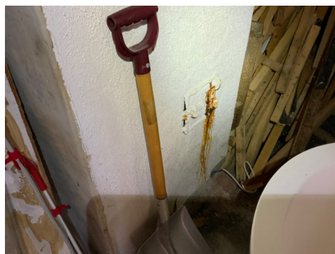
Rust og utett feieluke
