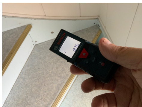
Lav takhøyde mellom trapp og tak
