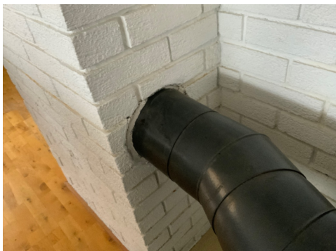
Skrekker rundt røykrørsinnføring
