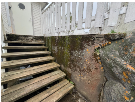
Div sprekker i støttemur/fundament
