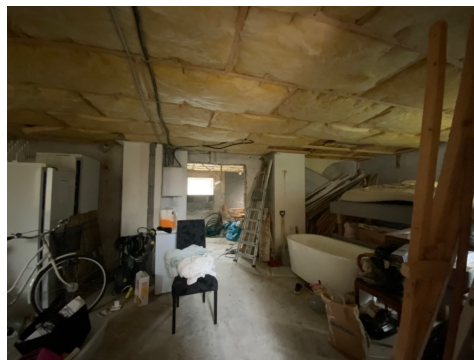
I kjeller er en del overflater revet
