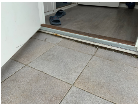
Ytterdør mangler vannbrettbeslag.
