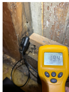
På kaldloft målt forhøyede fuktverdier på vegg under vindu
