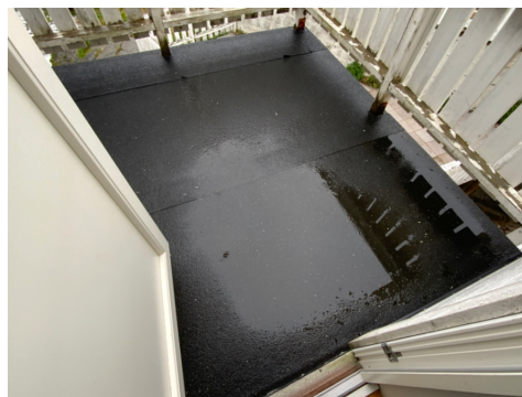
Ikke takhelning og mykt område, tyder på fuktskade.
