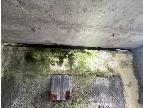
Under ingangsplass opp mot vegg sees det fukt og råte i treverk.
