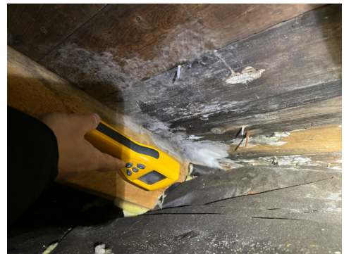
En del mugg og råte
