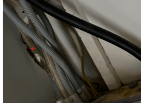
Mulig sot/svimerker på ledningsnett se bilde
