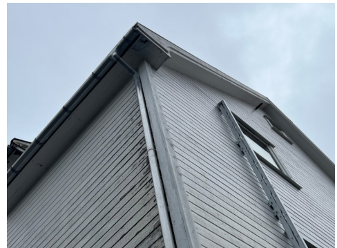
Ingen synlig ventilering
