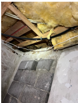
Stedvis synlig råte i etasjeskiller
