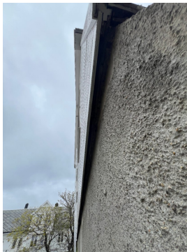
Ikke montert musesperre og utett vindsperre
