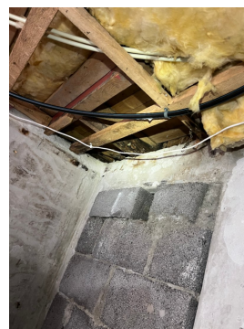
I kjeller sees det råde i overgang vegg - gulv
