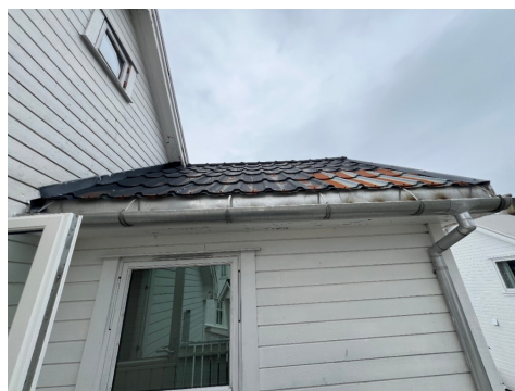
En del rust på metallplater
