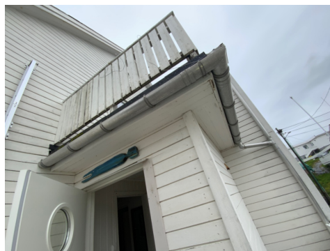
Ingen ventilering av konstruksjonen
