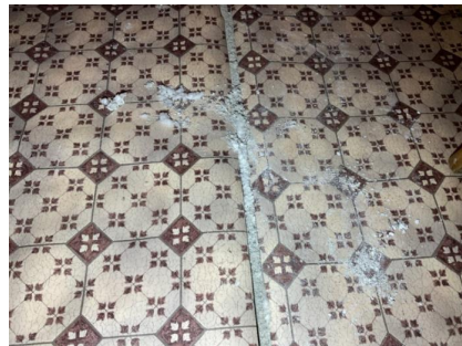
Sprekk i løst belegg, saltutslag fra betonggulvet.
