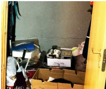
Liten sprekk i muren i kottet.
