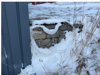
Støttemur mangler rekkverk.
