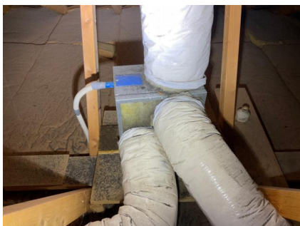
Vifteenheten på kaldloftet er ute av drift.
