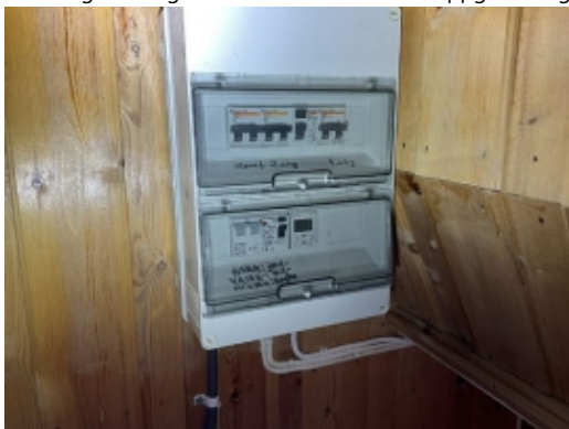
Enkel sikringsboks med seriemåler.
