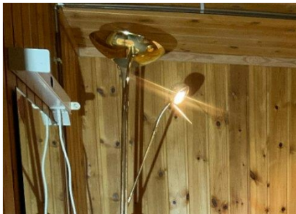
Lysarmatur uten lysrør og alternativ lyskilde bak.
