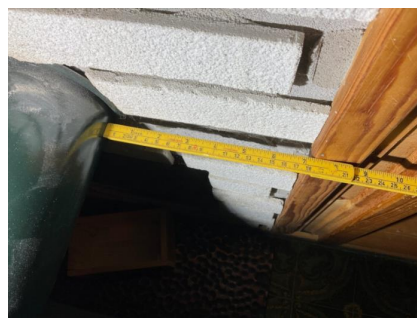
Røykrør for nært brennbart.
