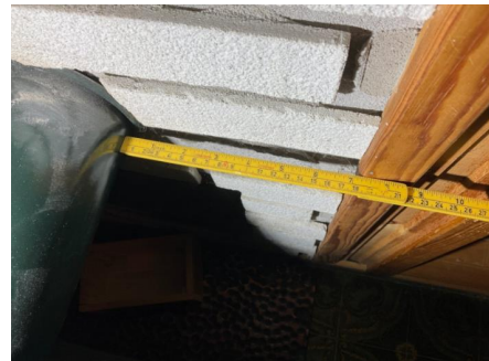
Røykrør for nært brennbart.
