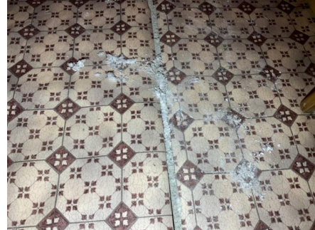
Sprekk i løst belegg, saltutslag fra betonggolvet.
