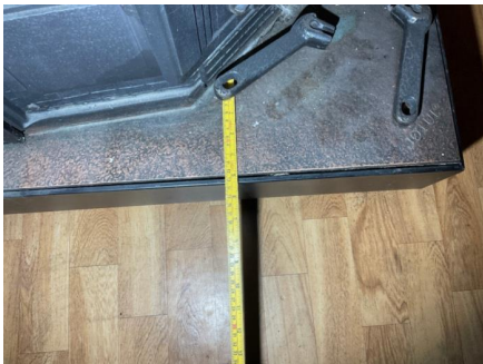
Ildfast plate foran ildstedet er for liten.
