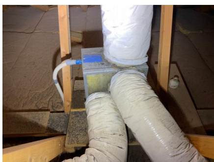
Vifteenheten på kaldloftet er ute av drift.
