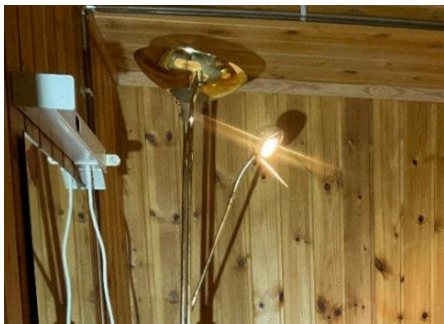
Lysarmatur uten lysrør og alternativ lyskilde bak.
