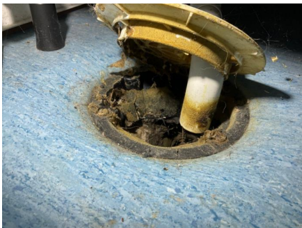
Sluk ved kabinettet med direkte avløp fra dette.
