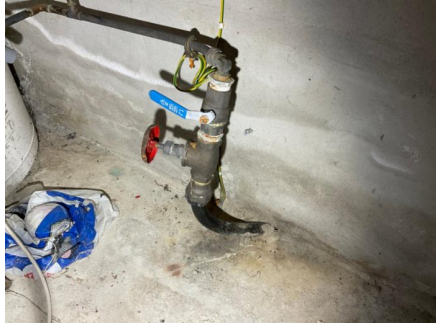
Vanninntak i PE(plastledning) og stoppekran i kjeller.
