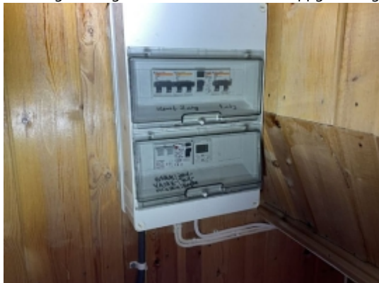
Enkel sikringsboks med seriemåler.
