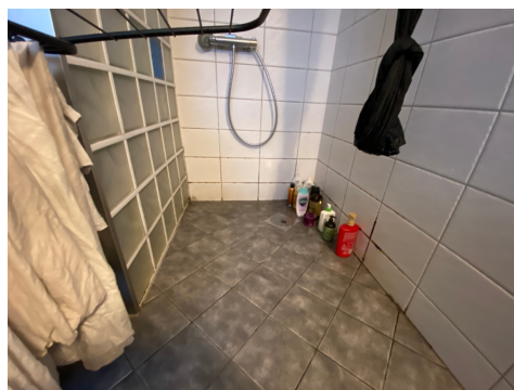
Bildet viser dusjnise med dusjgarnityr på vegg.
