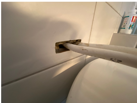
Bildet viser gjennomføring i vegg som ikke er tett.
