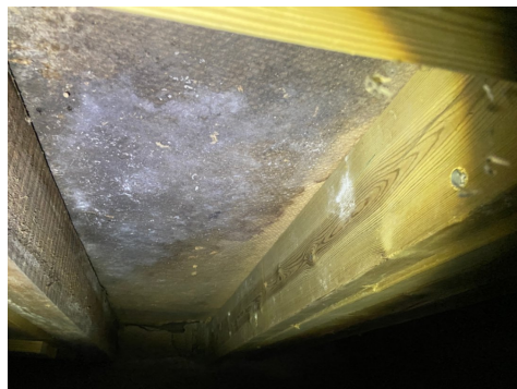
Bildet viser muggsopp på plater i krypkjeller.
