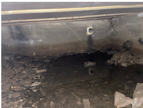
Bildet viser stående vann i krypkjeller.
