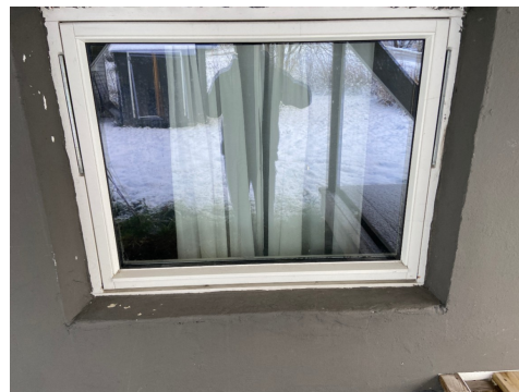
Bildet viser vindu med manglende beslagsløsning.
