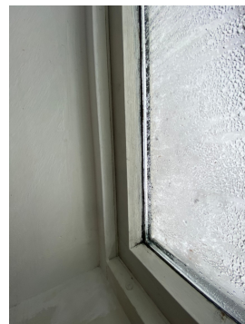
Bildet viser vindu med kondens og svertesopp.
