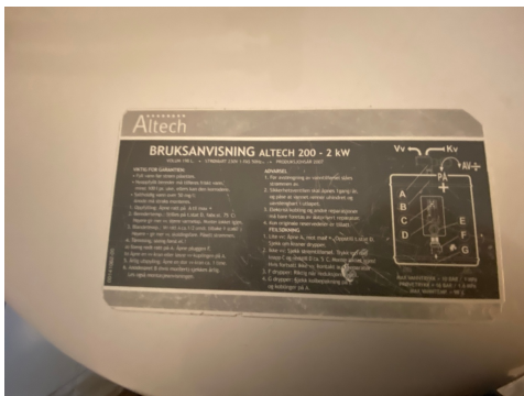
Bildet viser merke og produksjonsår på varmtvannstanken.
