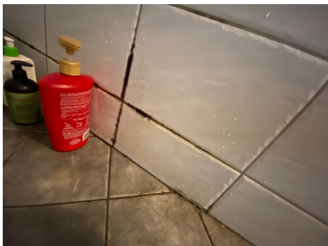
Bildet viser fuger i våtsone, i dusj.
