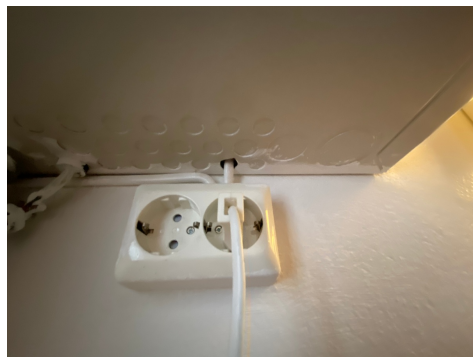
Bildet viser hull/kabelgjennomføring i sikringsskapet.
