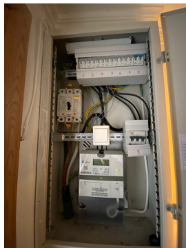
Bildet viser sikringsskap med automatiske sikringer.
