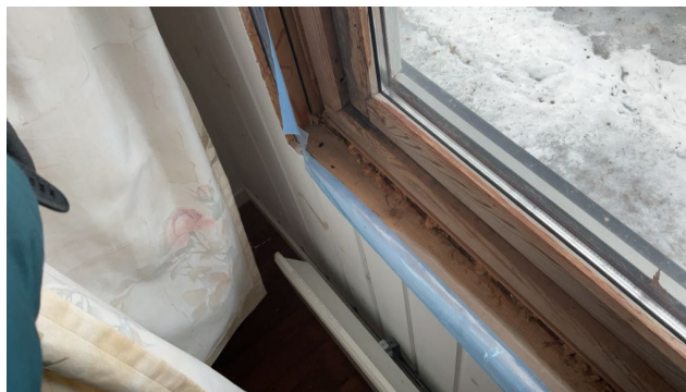
Ukjent utførelser i lukkede konstruksjoner, må hensyntas at avvik i utførelse/konstruksjonsoppbygging kan forekomme
