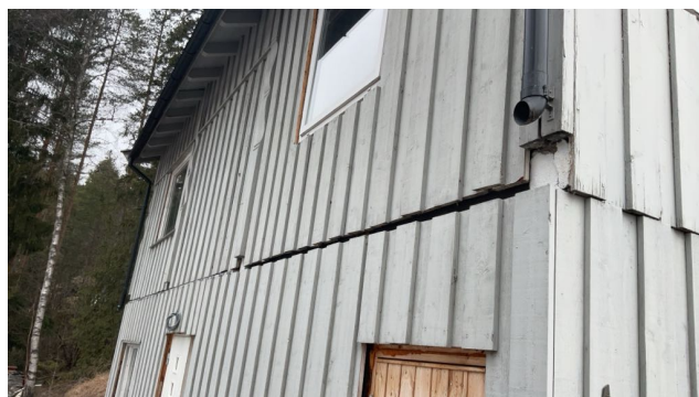
Uegnet løsning, gir fare for fukt i konstruksjonen
