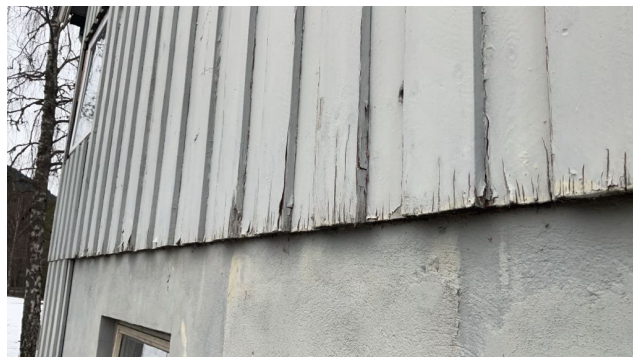
Vedlikeholdsetterslep med råte i kledning
