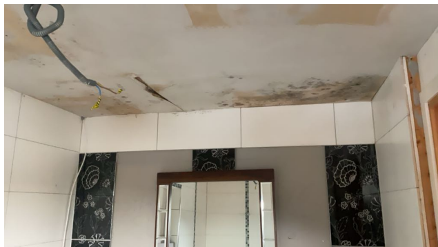
Fuktskader i himling med muggsopp, skade i vegger må påregnes
