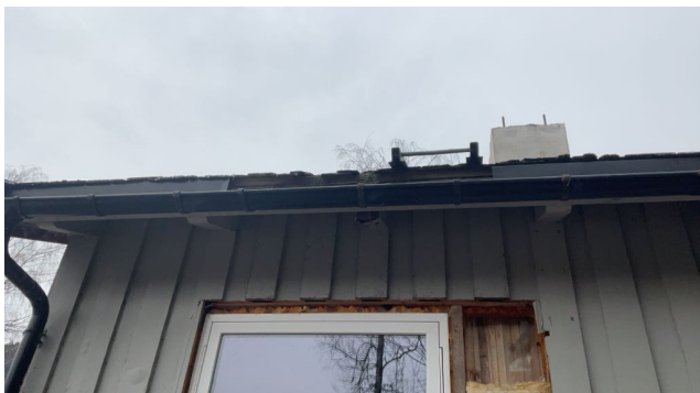
Skader med manglende forkant, synlig fuktskade i undertak/sperreender
