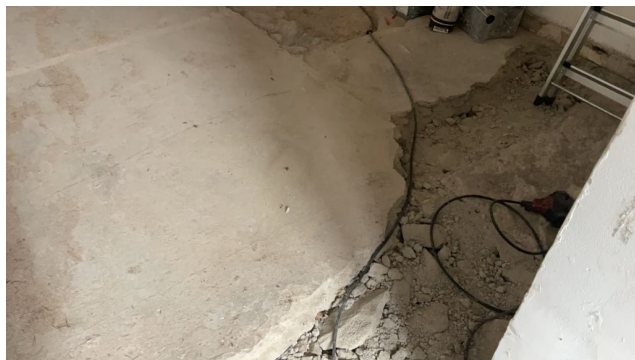
Spalter i gulv tilteknt til avløpsrør
