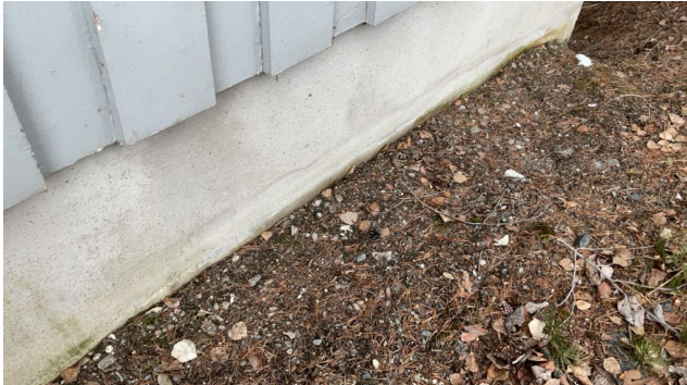
Ingen synlig drenering ved mur
