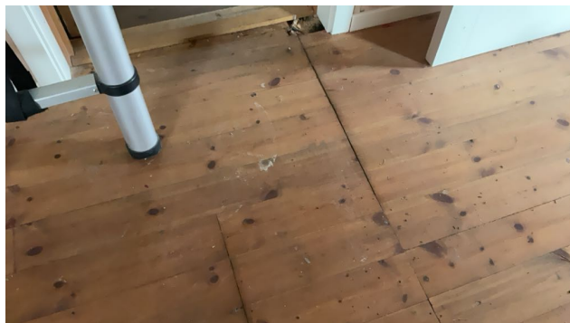
Slitsje og ikke fagmessig utførelse av gulv
