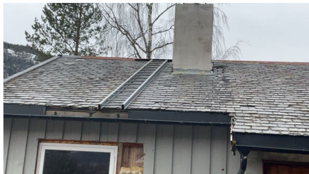
Skader på tak
