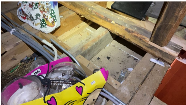
Manglende isolasjon og dampsperre
