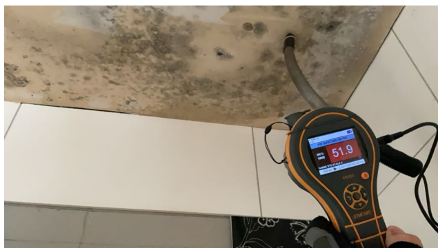
Ved fuktmåletaking av himling var det høye fuktutslag
