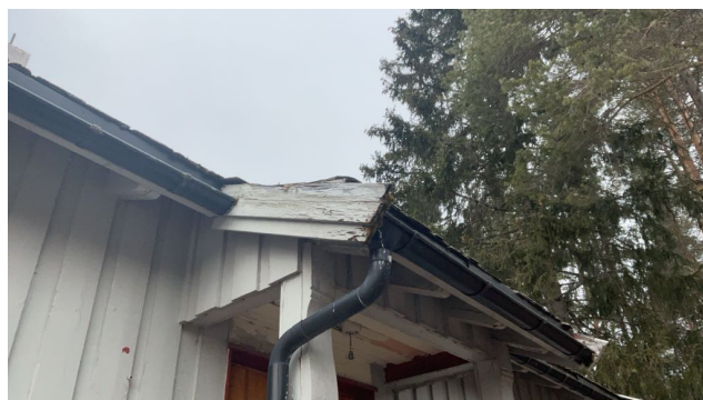
Råte i vindskie/forkant
