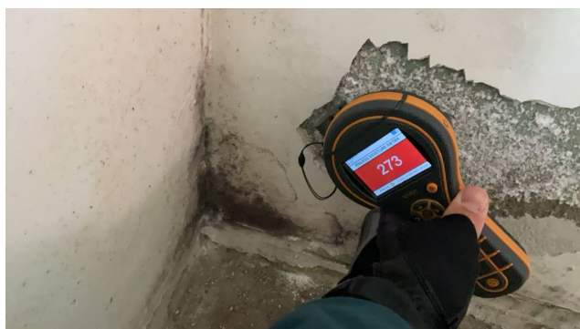
Fuktskjolder og saltutslag mot yttermur, ved fuktmåletaking var det fuktutslag der svikt i drenering er medvirkende årsak. Ikke registrert fuktsperre i grunn og anbefales
