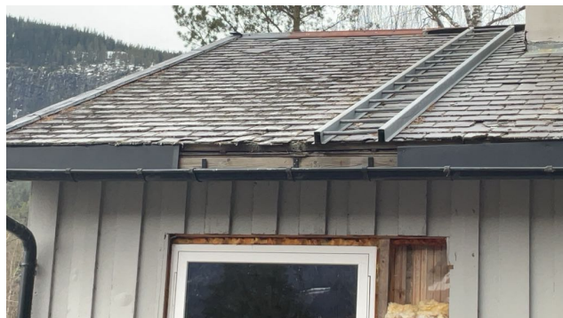
Skader på beslag og rust/utettheter i mønebeslag
