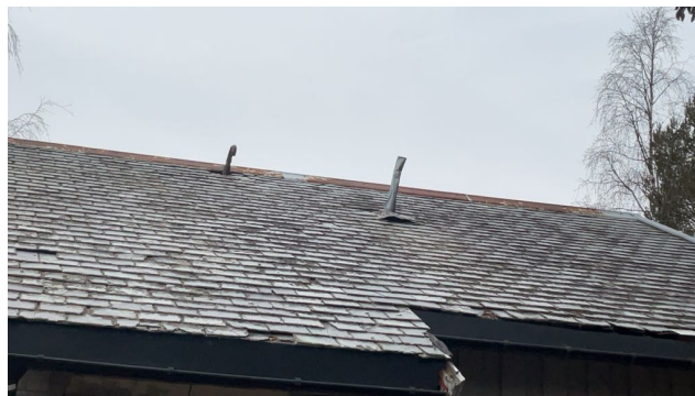
Bør endres lufterør på tekking
