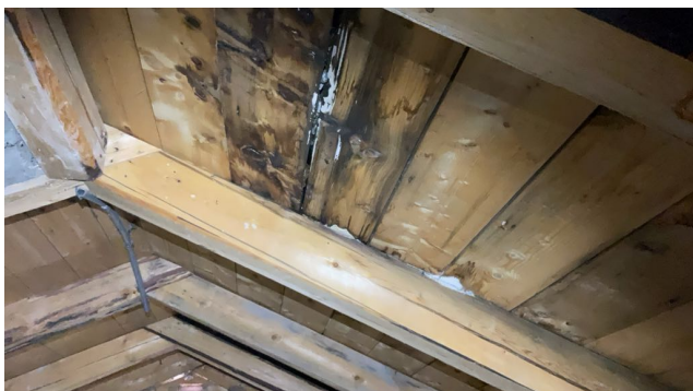
Skader i undertaktro med sopp på sperrer.
