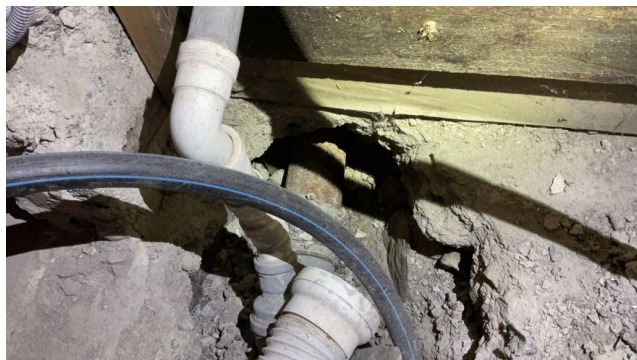
Rust på støpejern bunnledning, uegnet bruk av elastisk rør
