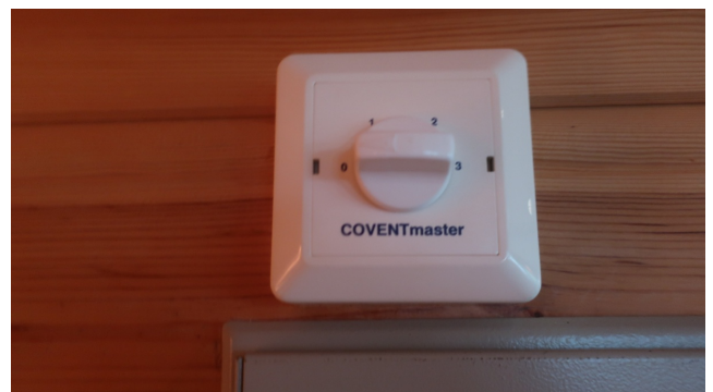
Styring av ventilasjonsanlegg plassert på loftet.
