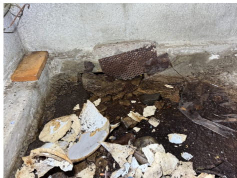
Tilsig av vann i et hjørne på krypkjeller
