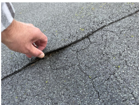
Begrenset liming i en skjøt
