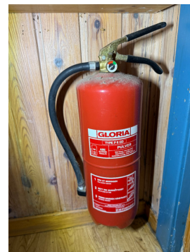
Eldre 6 kg må skiftes ut til nytt
