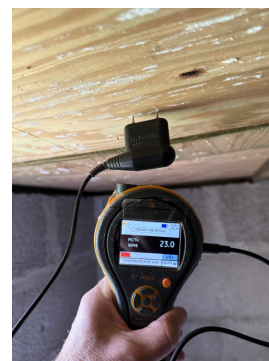
Spor av sopp og utslag i etasjeskiller fra krypkjeller med 23% vektall
