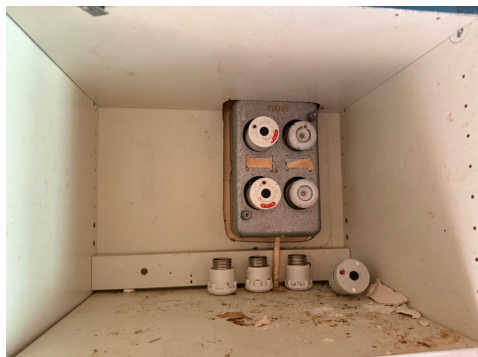
Skrusikringer med skap i kjøkkenskap.
