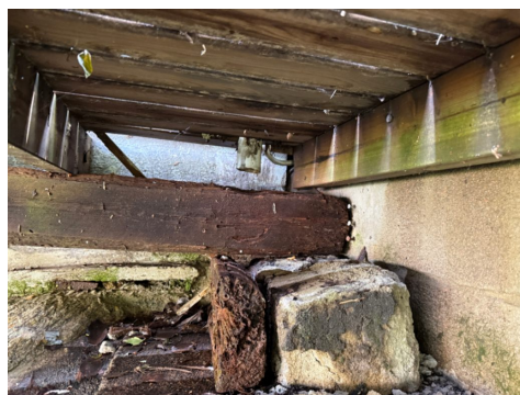
Råteskadet svill til bæring av terrasse (takvann må ledes bort)
