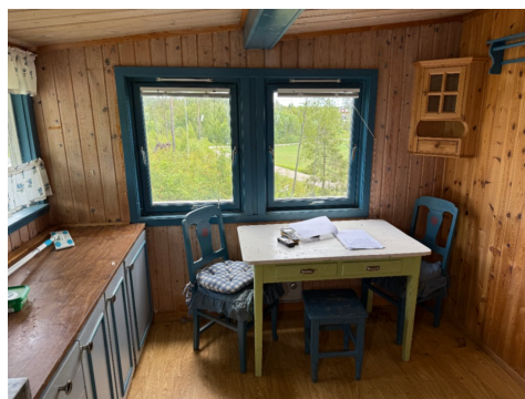
Isolerglass i 2 kjøkkenvinduer
