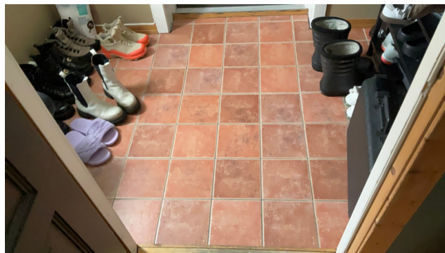
Bom i fliser og knekte fliser i vindfang.
