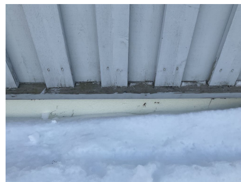
Ingen lufting nede på veggkonstruksjonen.
