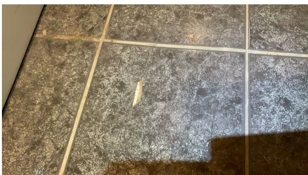
Sprekk i flis.
