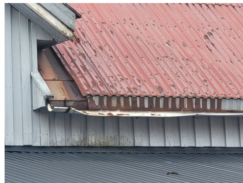
Rust på takplater.
