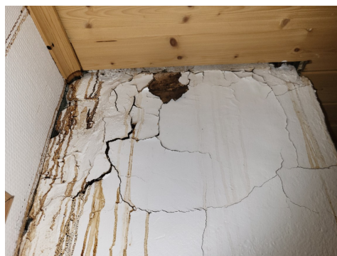
Sotvann på pipe i loftetasjen
