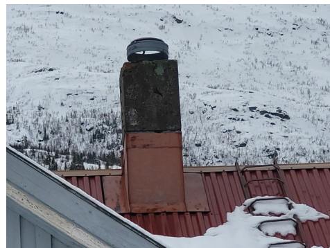
Manglende toppbeslag på pipe.
