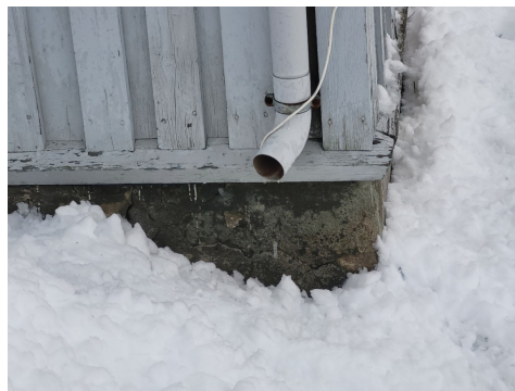
Riss og sprekk i grunnmur.
