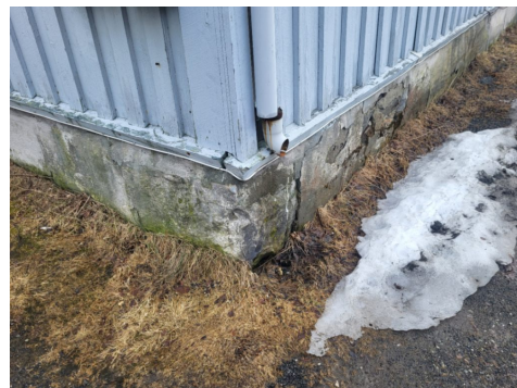
Manglende overvannsrør under bakkenivå
