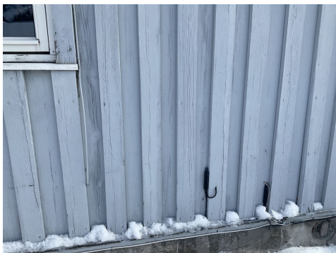
Sprekker i kledning.
