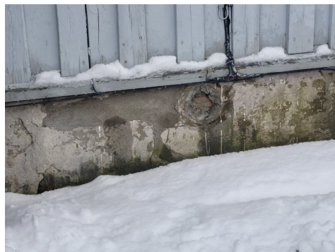
Riss og sprekk i grunnmur.
