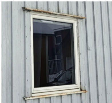
Rust på beslag, skade på karmbord.
