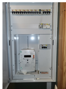
Sikringsskap med automatiske sikringer.
