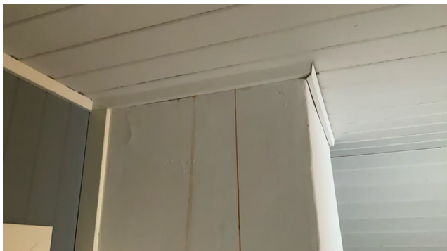
Spor av sotvann på pipe i loftetasje.
