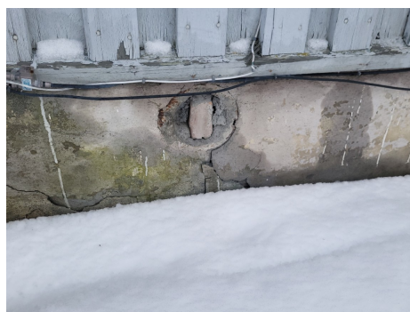
Ingen ventilering på grunnmur.
