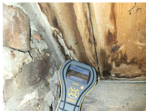
Påvist fukt ved pipe i takkonstruksjon.
