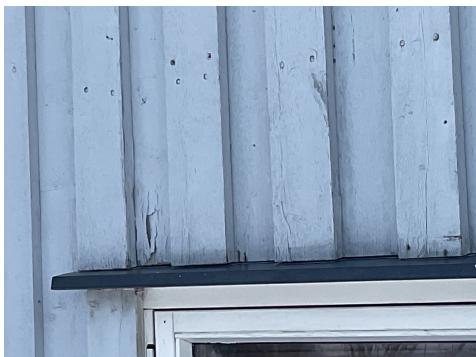
Malingsavflassing på kledning
