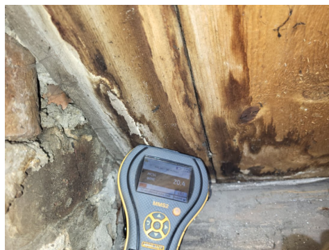
Fukt påvist ved pipe.
