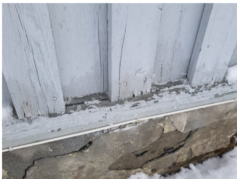
Løsnet puss og sprekker i grunnmur.
