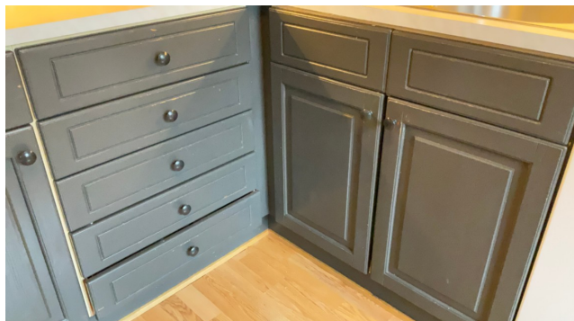
Slitasje på skap.
