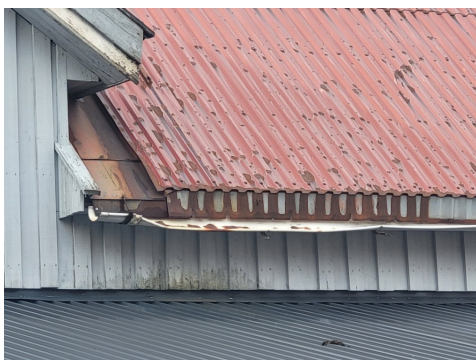
Ødelagt takrenne på hovedtak.
