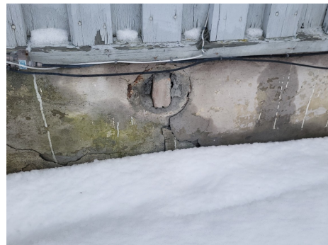
Løsnet puss og sprekker i grunnmur.
