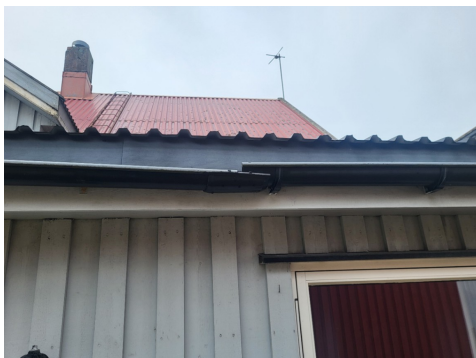
Brudd i takrenne over stuedel.
