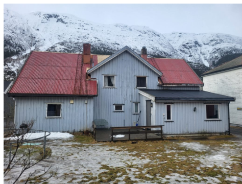
Stående vann mot grunnmur.
