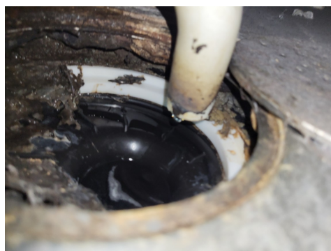
Sluk under dusjkabinett
