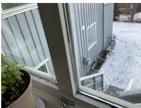
Kondens, fukt og noe sopp på pakning og glass
