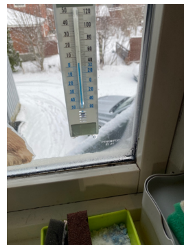
Kondens, fukt og noe sopp på pakning og glass.
