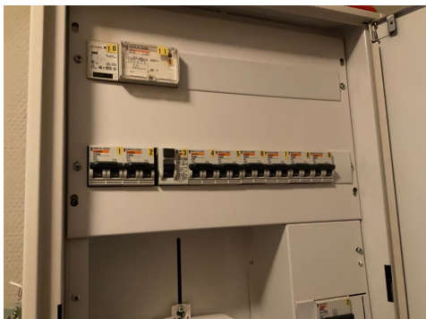
El-skap plassert i gangen.
