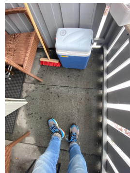
Balkong/terrasse ligger over innredede boligrom, usikker konstruksjon. Konstruksjonsutførelse gir økt fare for skader.
