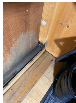
Døren har sopp og råteskader.
