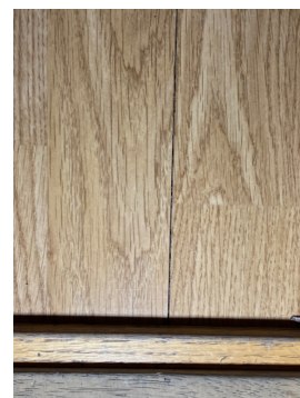
Laminatgulv har stedvis svellinger/glipper i skjøter.
