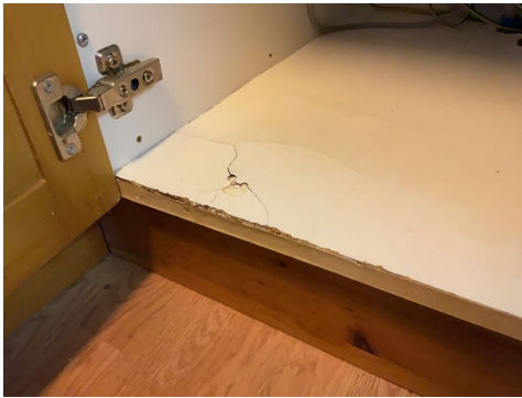
Fuktskader på skog uner oppvaskbenk.
