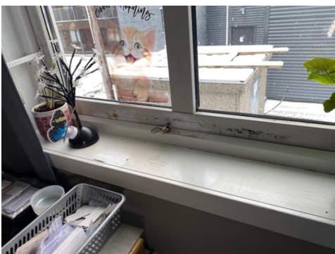
Kondens, fukt, råteskader og sopp på pakning og glass.
