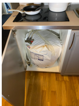
Varmtvannstank montert i kjøkkenskap på ca. 80 liter, prod. år 1998
