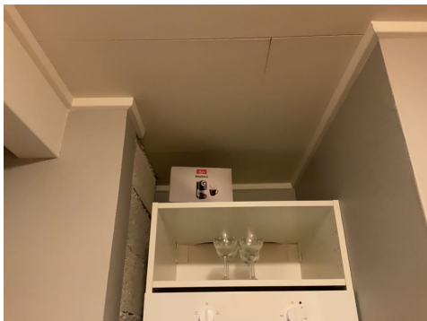
Utsvelt himlingsplate på kjøkken (tørt på befaringsdagen)
