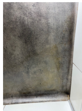
Det er ved vanntest påvist større vannansamlinger, renner ikke mot sluk.
