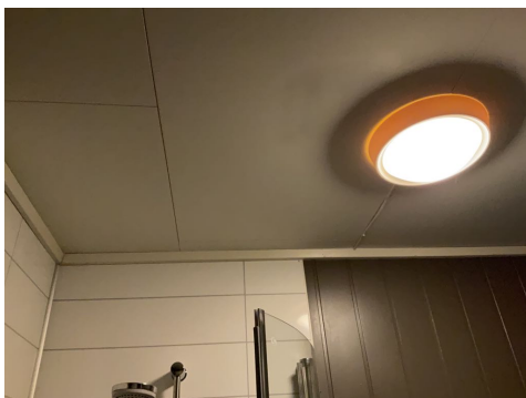
Fuktmerker og utsvelt himlingsplate over dusjsone
