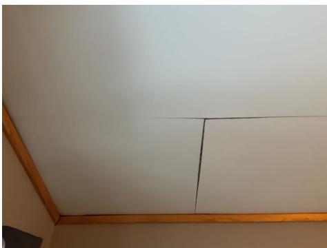
Fuktskader flere plasser i taket på soverom.
