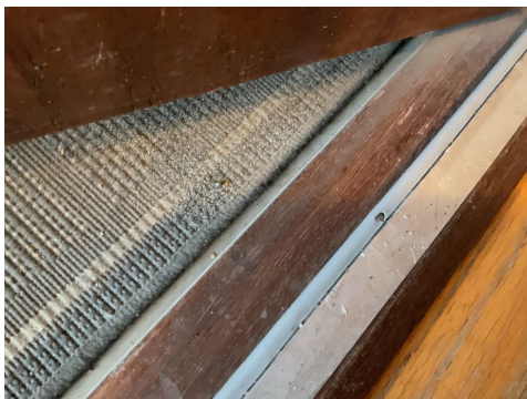
Skade i pakning.
