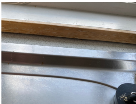
Manglende fuging mellom benkeplate og vegg
