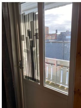
Glass i døren er knust, døren kan ikke lukkes.
