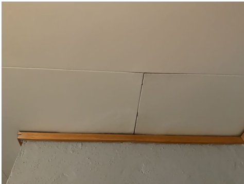
Fuktskader i tak.
