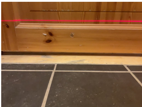
Tilluftspalte under dør
