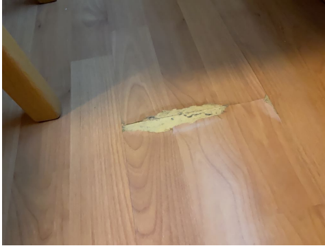
Skade i laminatgolv på kjøkken, gulvet har ellers noe svellinger i skjøter.
