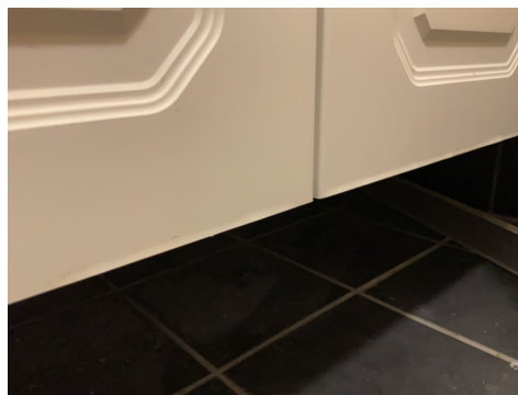
Dører er utselt i nedkant
