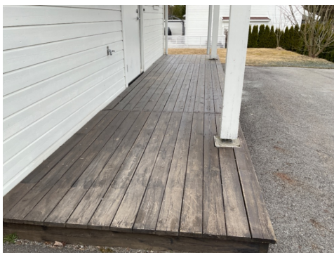
Ca. 12 kvm., værslitte terrassebord + avflassing av maling på stolper.
