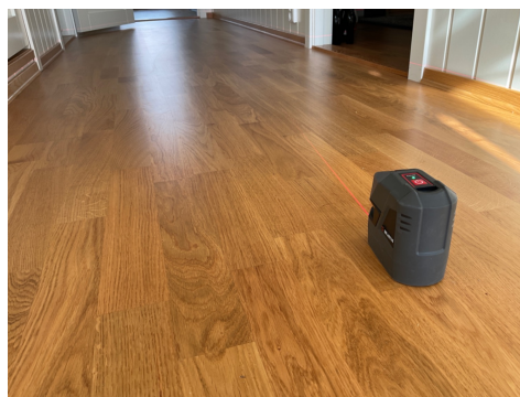
Nivellering trapperom 2. etasje, avvik, ca. 10 mm.
