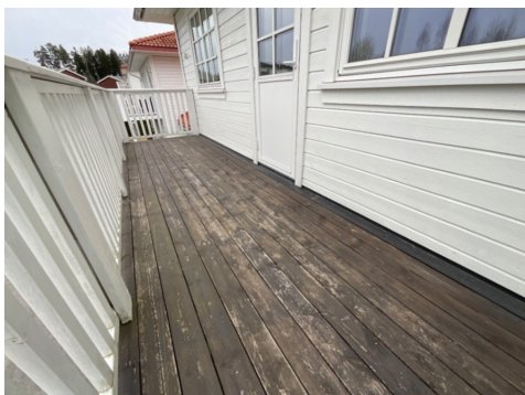
Ca. 10 kvm., værslitte terrassebord + avflassing av maling på rekkverk.
