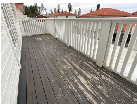
Ca. 9,5 kvm., værslitte terrassebord + avflassing av maling på rekkverk
