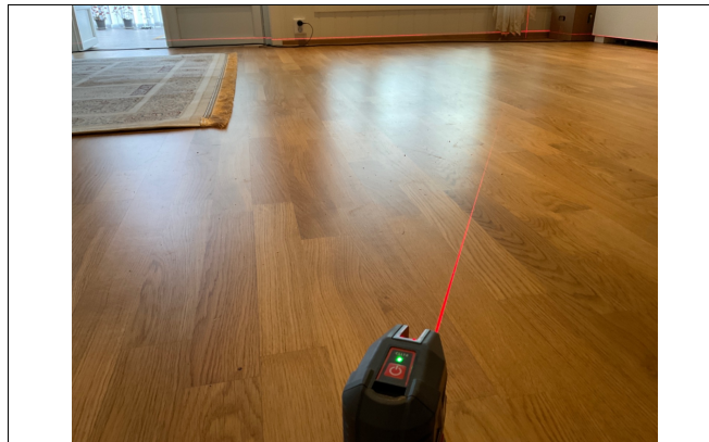
Nivellering stue, avvik, ca. 10 mm.
