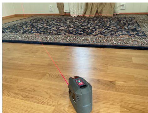
Nivellering soverom 2. etasje, avvik, ca. 10 mm
