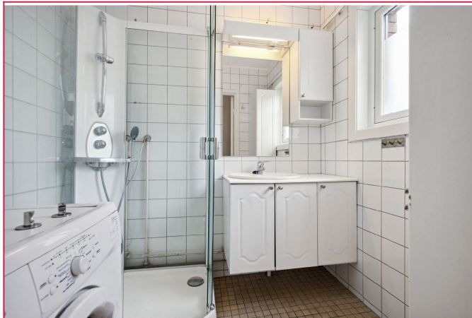
Bad med dusj og vaskemaskin
