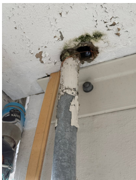
Løstnet avløpsrør fra balkongen over.
