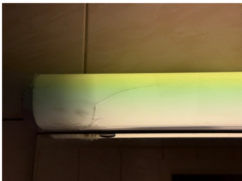
Sprekk i deksel til speilbelysning
