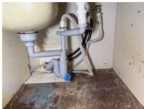
Rørpropp i kjøkkenbenk
