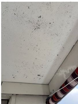
Løstnet maling flere steder på balkongen (tak og vegger)
