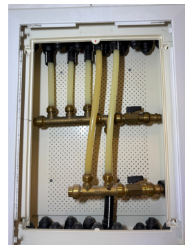
Rørskap på toalettromsvegg med stoppekraner.
