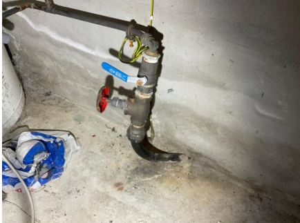
Vanninntak i PE(plastledning) og stoppekran i kjeller.
