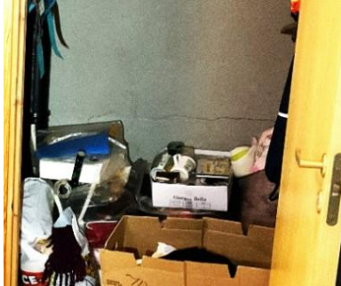
Liten sprekk i muren i kjøkkenet.
