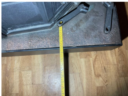
Ildfast plate foran ildstedet er for liten.
