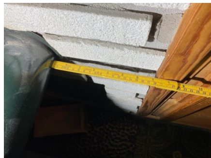
Røykrør for nært brennbart.
