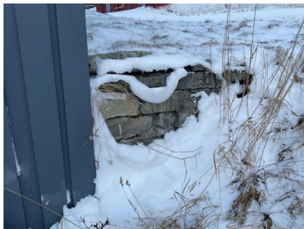
Støttemur mangler rekkverk.
