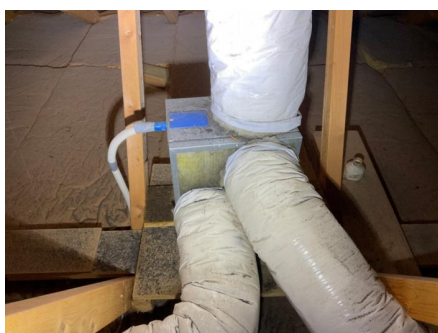
Vifteenheten på kaldloftet er ute av drift.
