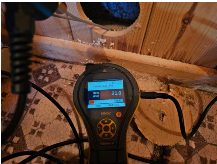
Måling viser 21 % fuktinnhold i svilla.
