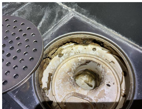
Synlig tettesjikt av smøremembran fra sluk
