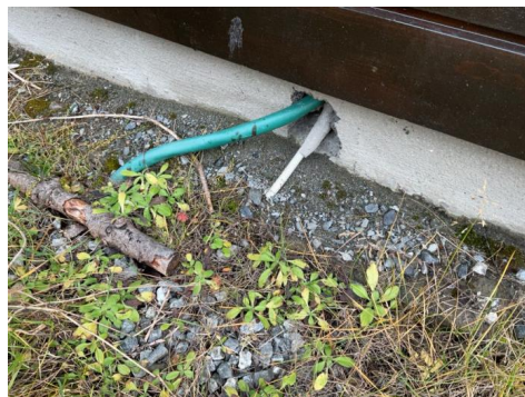
Hovedledning bør ha sikring/vern
