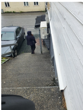
Rekkverk med store åpninger mot vest
