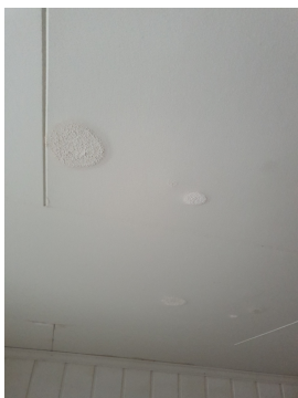
Fukt skader i himling i boder i kjeller
