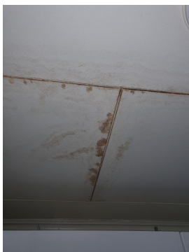
Lekkasje merker i tak som må utbedres/kontrolleres nærmere.
