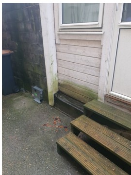
Overflater på kledning til bod i kjeller.
