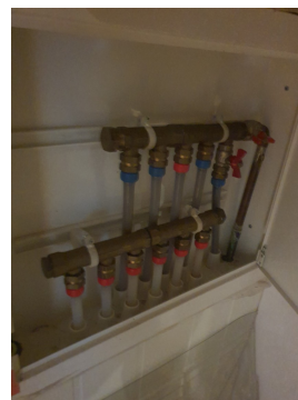
Rør i rør skap i hovedetasjen, men ikke kursfortegnelse eller utførende. Heller ikke stoppekran.
