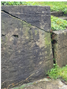
Forstøtningsmur med sprekker og uten rekkverk.
