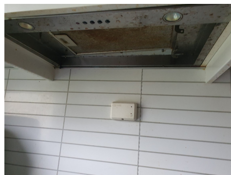
Avtrekket trenger vedlikehold og oppgradering
