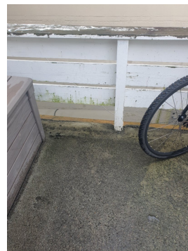
Rekkverk 80 cm høyde som er for lavt
