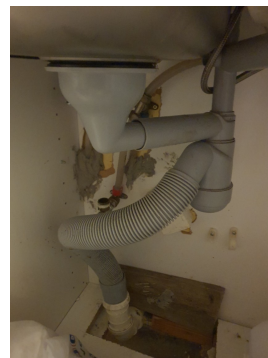
Tegn til at skadedyr har vært i området.
