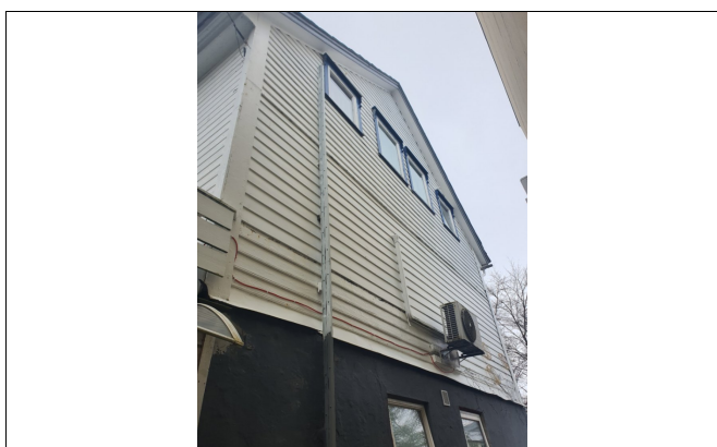
Rømningsstige fra loft og varmepumpe til hovedetasjen.
