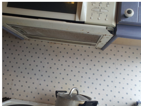
Ventilator er skadet og fungerer ikke!
