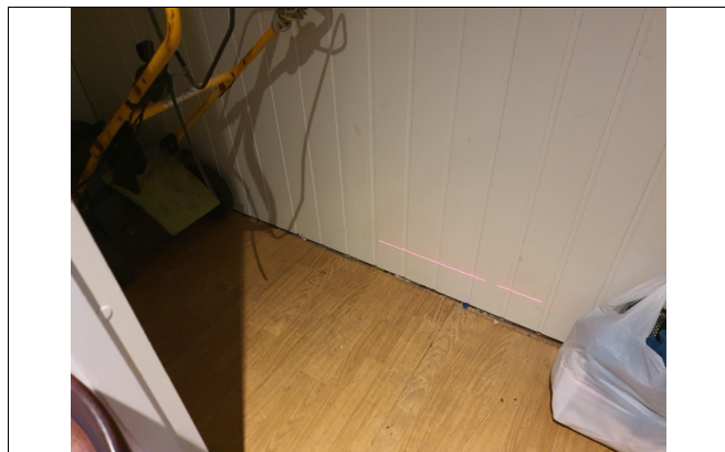
Vegg som er bygget mot trapperom til loftsetasjen uten listverk m.m.
