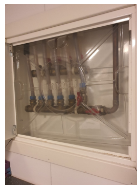
Rør i rør skap i kjeller som ikke alle rør er i rør i rør! Ser kopperrør inn til vannstammen. Det er ikke benevnelse
