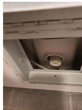
Luke inn til bereder som har en kant oppfør vann kommer inn til bad/vaskerom.
