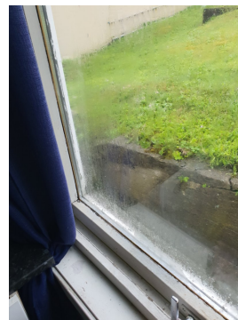
Lite tilluft til kjøkken som en ser igjen på glass i vindu.
