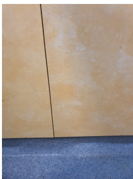
Åpning i skjøter på baderomsplater.
