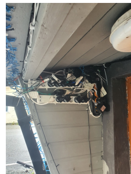
Utvendig el anlegg som må kontrolleres av el.
