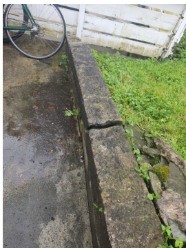
Sprekker i mur og skjevheter etter jordtrykk.
