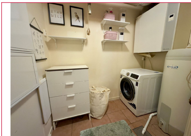
Teknisk rom kombinert som vaskerom praktisk anlagt ved entréen.
