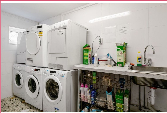
Felles vaskerom i kjeller med utslagsvask og plass til både vaskemaskin og tørketrommel
