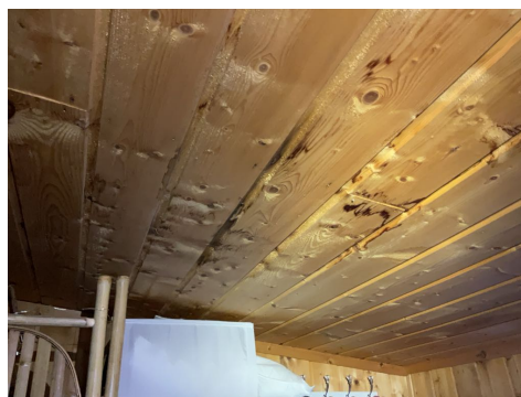
Fuktskjolder i himling stedvis, ukjent tilstand i lukkede konstruksjoner og lekkasjer fra yttertak kan føre til skade i tak
