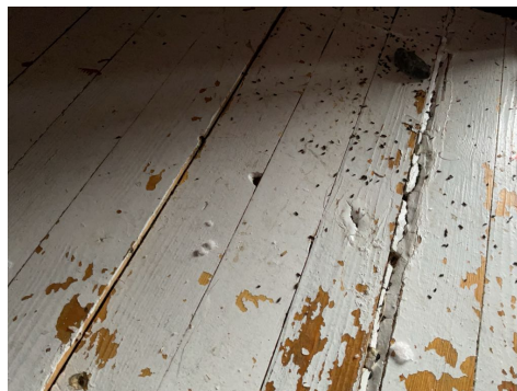
Avvik i skjøt og nedsenk i overgang
