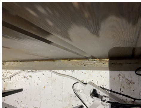
Glipper mellom gulvlist og vegg, setninger/bevegelse i bygg som årsak.
