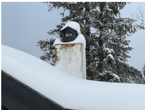
Avskalling av puss, anbefaler heldekkende pipebeslag og fotbeslag over møne
