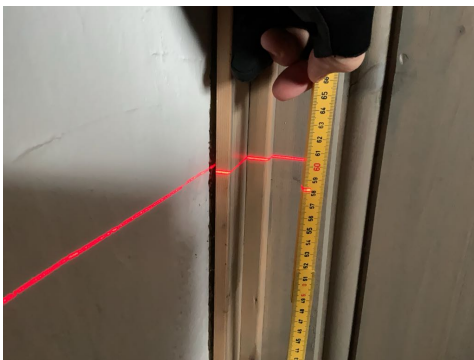
Målt høyde 58,5 cm høyde i motsatt ende av rommet, avvik på 11 cm.
