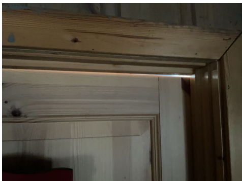
Skjevheter i ytterdør der dørblad henger i karm og glippe med luftlekkasjer.
