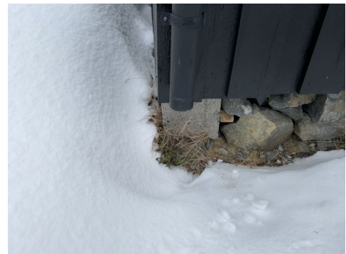
Manglende bortledning av takvann
