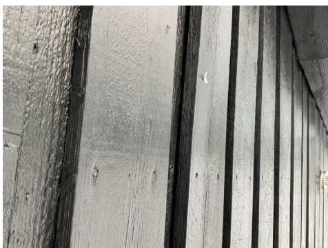
Kuving av kledning, innganger for mus/skadedyr og ukjent tilstand i lukkede konstruksjon der bemerkninger innvendig tilsier skader i konstruksjonen
