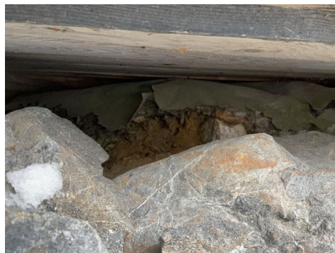
Press fra grunn mot gulvkonstruksjon
