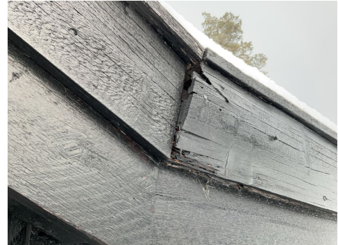
Råte i vinds kier
