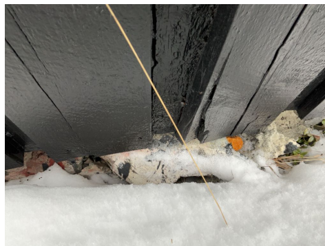
Sprekk med press fra fundament
