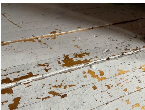
Slitasje på gulvoverflate
