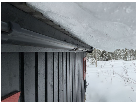
Nedbøying av ene siden trolig som følge av is/snøpress, feil fall på renne
