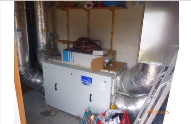
Ventilasjon på utvendig bod
