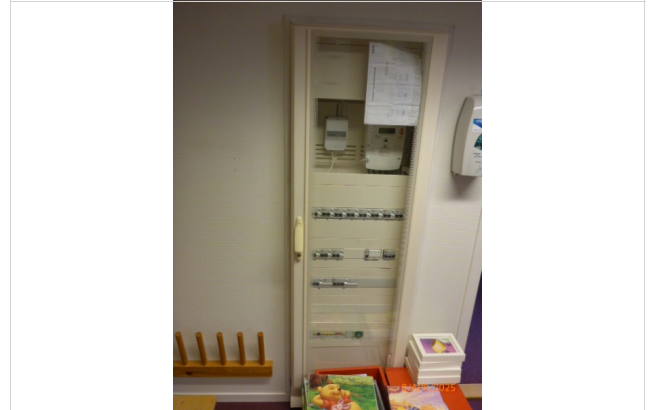
Sikringstavle på gang
