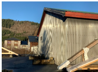
Oversikt over bygget. Det er skader på flere veggplater.
