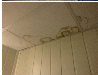
Gang. Fuktmerker etter tidligere lekkasje fra tak.
