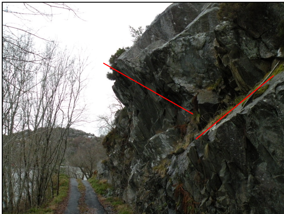
Figur 4: Skjæring over adkomstvei til eiendommene, delvis sprekkeavgrensede blokker på glideplan.
