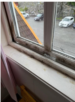
Vindu på bakside på loft har svartsopp og bærer preg av kondensering
