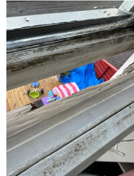
Vinduer i skråfelt på loft i front av bygget har store råteskader å må skiftes
