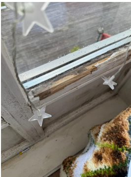
Viser kondensering og fuktskadet vindu i front loft
