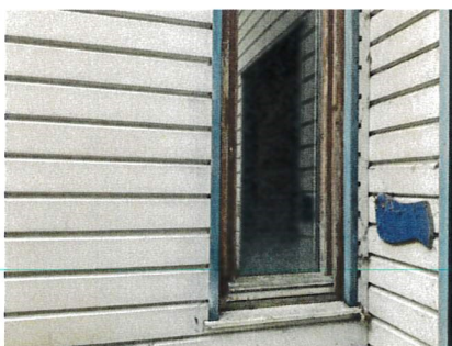
Vinduer i generelt dårlig stand
