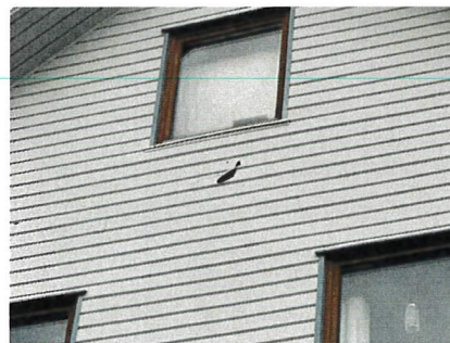
Slitt kledning med enkelte skader
