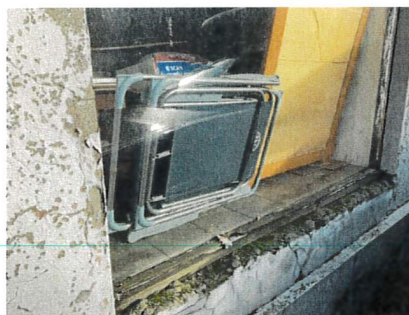
Vinduer i generelt dårlig stand.
