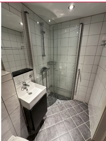
Flislagt bad med downlights i tak og opplegg for vaskemaskin.
