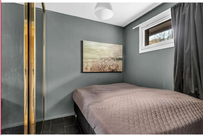
Rom benyttet som soverom. Rommet er ikke godkjent som soverom.
