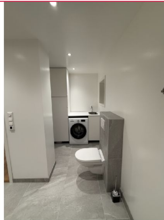
Downlights i himling og varmekabler i gulv
