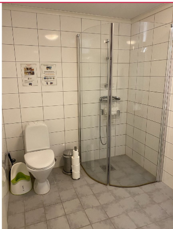
Flislagt bad med hjørnedusj i kjeller. Varmekabler
