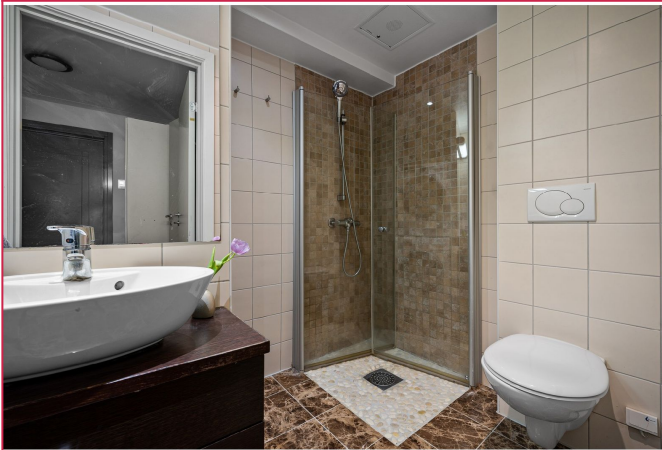
Baderom med varmekabler
