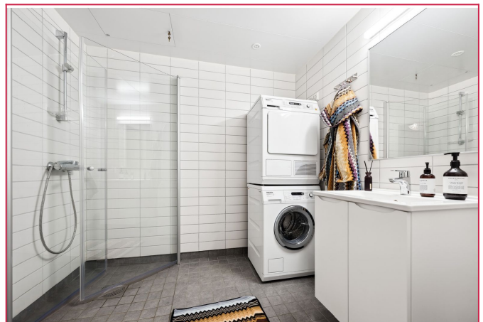
Baderom/vaskerom med varmekabler i gulv og opplegg for vask- og tørketrommel
