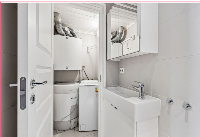
Teknisk bod, med varmtvannstank og vaskemaskin
