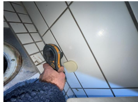
Fuktutslag langs sokkel i dusj.
