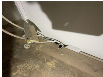
Rørøpplagg, ikke tilfredstillende blendet eller utført.
