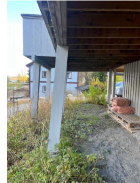
Skjevheter i bærekonstruksjoner
