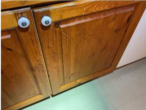
Slitasje/riper på innredning
