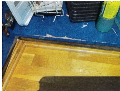
Innredningen er slitt.
