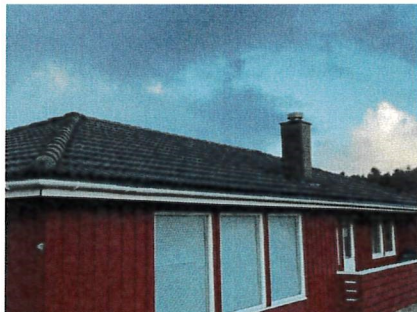
Takstein generelt slitt.
