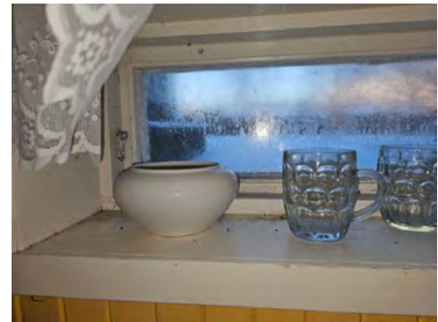
Dugg/fukt på vindu
