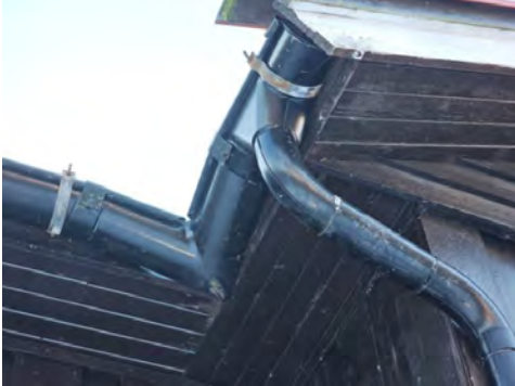
Skade i vinkel i takrenne
