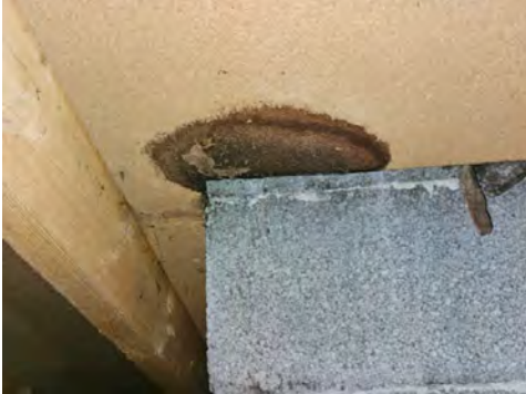
Merke etter tidligere fukt ved pipe
