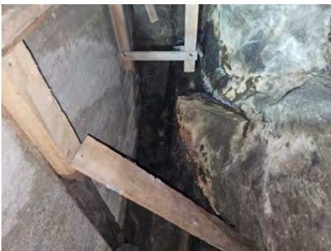
Fukt/vann i krypkjeller
