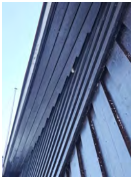
Tak kasse virker å være løs mot nord-vest
