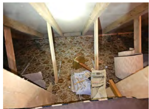
Ingen lufting ved raft
