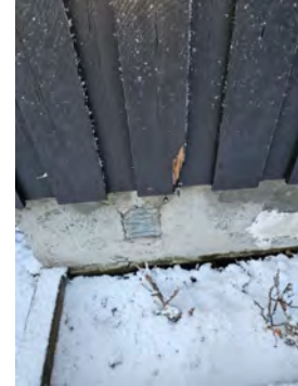
Noe mindre råteskader på kledning
