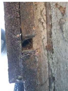
Meget begrenset lufting bak kledning
