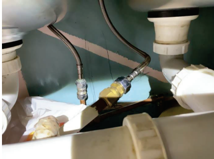
Trykkførende vannrør i oppvaskbenk kjøkken er ikke tilstrekkelig klamret.
