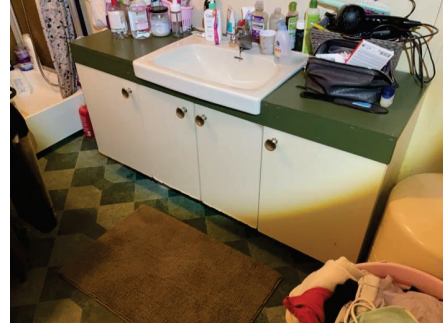
Skader på innredning.
