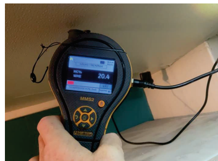
Økt fuktkvotie måles i himling/-innvendig tak.
