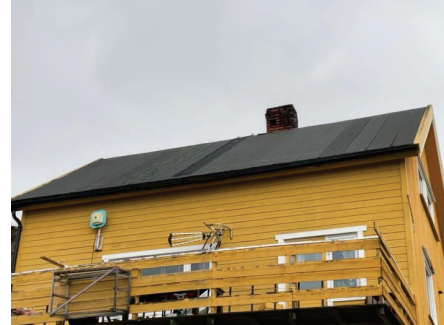
Høyere slitasjepreg og skade registrert.
