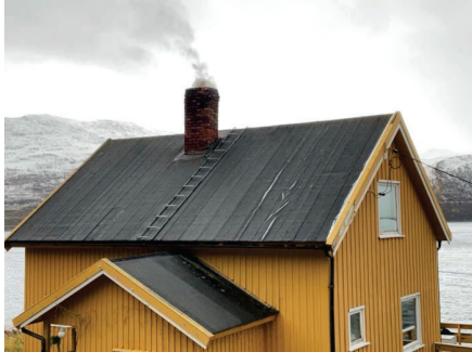
Høyere slitasjepreg og skade registrert.
