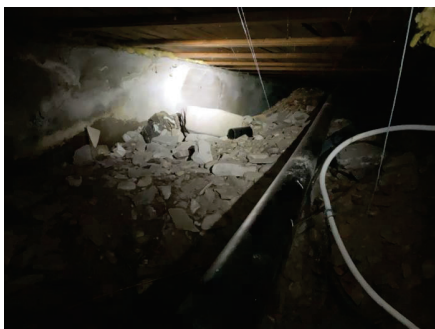
Manglende dampspærre på grunn og ingen ventilering av kryp kjeller.
