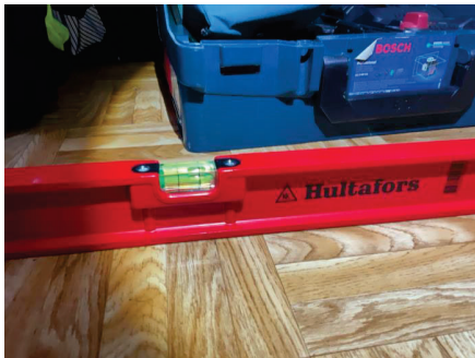
Innvendig gulv med markant horisontalavvik.
