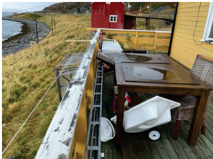
Veranda med markant slitasje.
