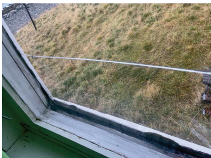
Vindu på loft med råte- og glasskade.
