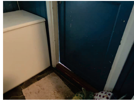
Ytterdør inngangsparti elde montasje med markant lysåpning mellom karm og dørblad.
