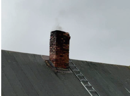
Pipe over yttertak registreres svekkelser/-skade.
