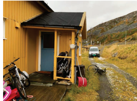
Svikt i fundamentering tilbygg.
