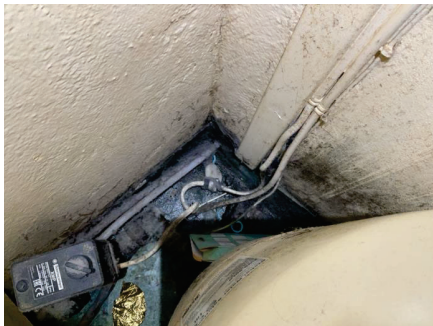
Svertesopp og fuktskader i platekledning.
