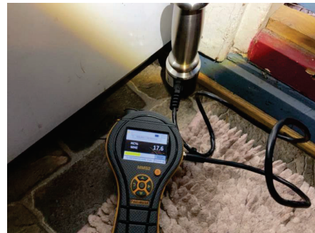
Fuktmålinger i vf/-inngangsparti.
