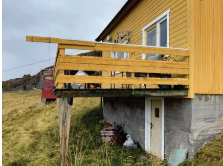
For stor åpning i rekkverk.
