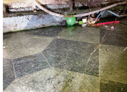
Trykkførende vannrør på bad er ikke tilstrekkelig klamret. Kondensering og det drypper fra rørskjøt.
