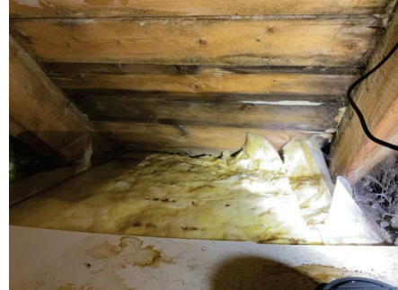
Misfarging og svertesopp i taktro ned mot takfot.
