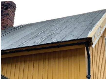
Pappspiker langs randsone har løsnet fra underliggende innfesting.
