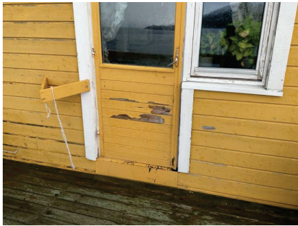
Verandadør med markant slitasje og funksjonssvikt.
