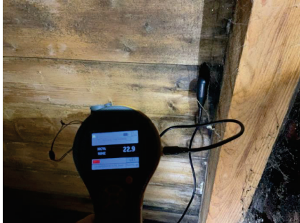
Misfarging og økt fuktkvotepåles i taktro.
