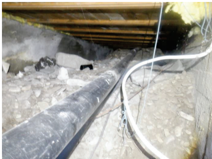
Svak klamring/-oppheg av avløpsrør i krypkjeller.
