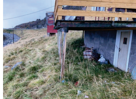
Søylor med loddavvik.
