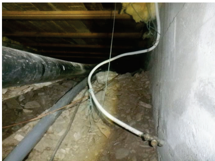
Trykkførende vannrør er ikke frostsikret og svak klamting av rør.
