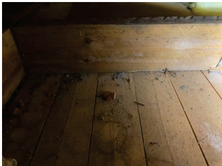
Ingen dampspærre mellom innredet areal og kaldloft.
