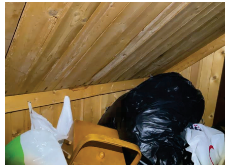
I raftekott avdekkes det fuktsjolder i innvendig tak.
