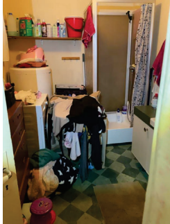
Våtrom høyt slitasjepreg og utsatt vedlikehold.
