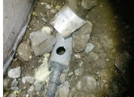
Skade sprekk i avløpsrør i kjeller.
