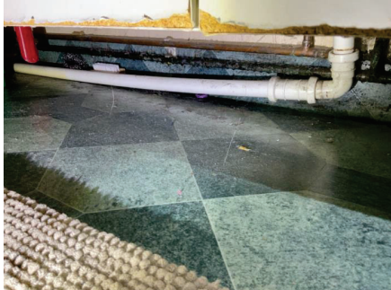
Bad avløpsrør er ikke klamret.
