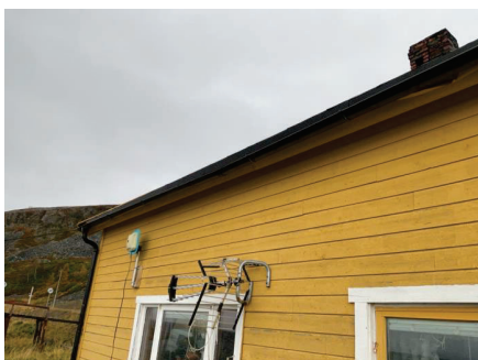
Sørfasade heng på takrenne.
